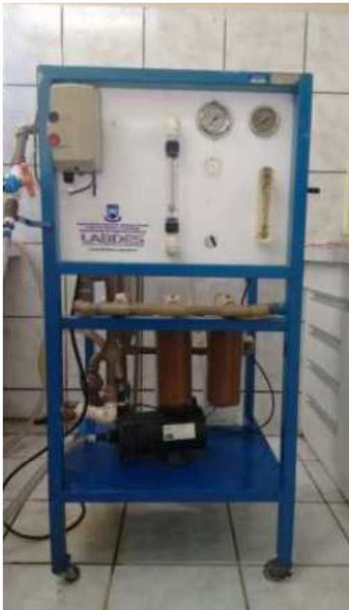
Figura 7: Sistema de dessalinização
