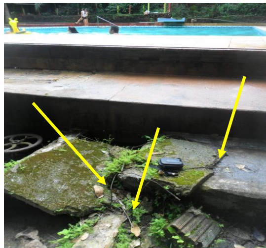
Figura 25 – Pontas de ferro exposta próximo à piscina, representando perigo aos visitantes.
