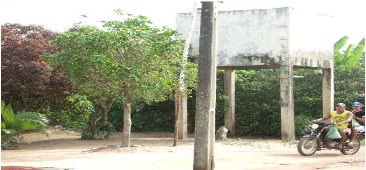
Figura 5 - Caixa que abastece o assentamento com água
