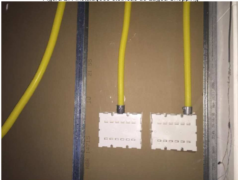
Figura 27: Instalações elétricas do Lagoa Shopping
