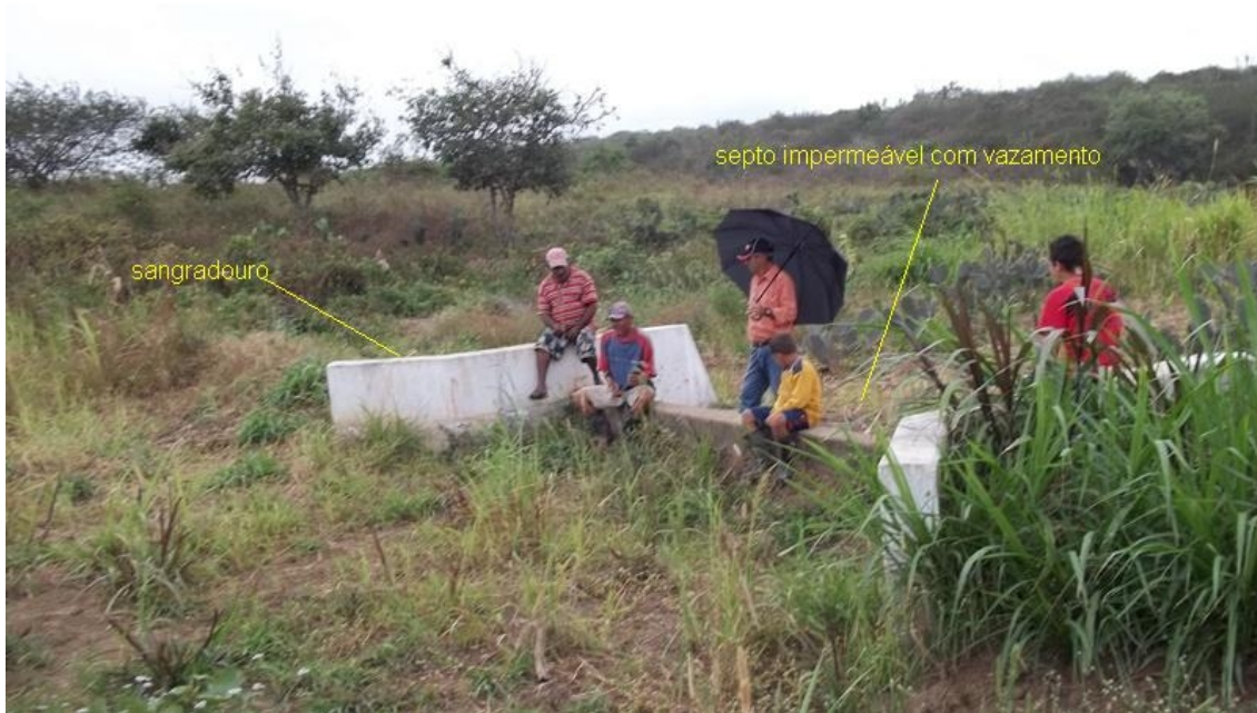
Figura 11. BS- 3 com vazamento no septo impermeável. Fonte: Acervo do autor, 11/2011.
