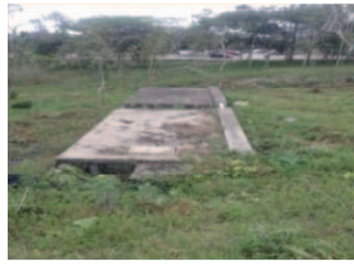
Figura 24 – Sistema de tratamento dos efluentes.
