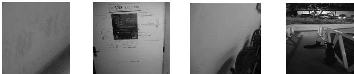
Figura 01: Marcas de pés nas paredes dos corredores; marcas de cadeiras nas paredes das salas de aula; a colagem indevida de informativos nas portas das salas de aula e a presença de animais abandonados.
