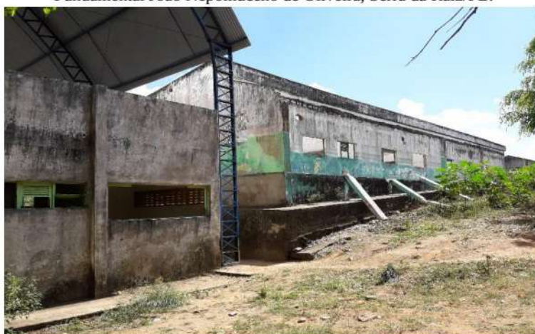
Figura 1: Registro atual do prédio em ruínas da Escola Municipal do Ensino Fundamental João Nepomuceno de Oliveira, Serra da Raiz/PB.
