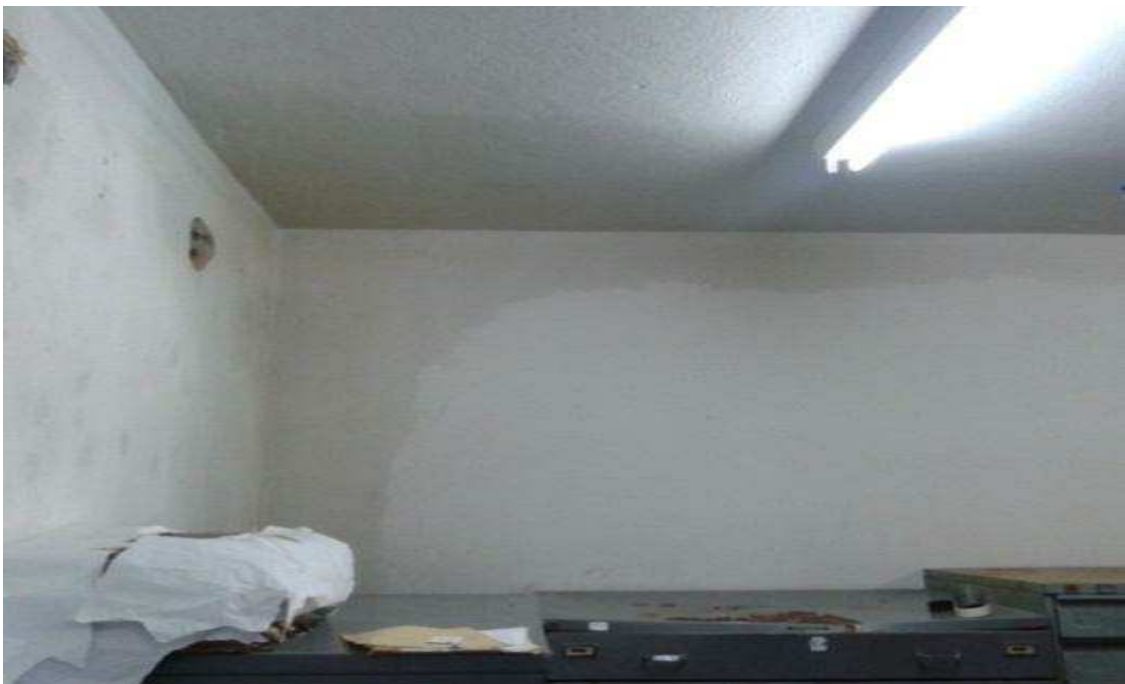
Figura 15: Infiltração no teto do arquivo
