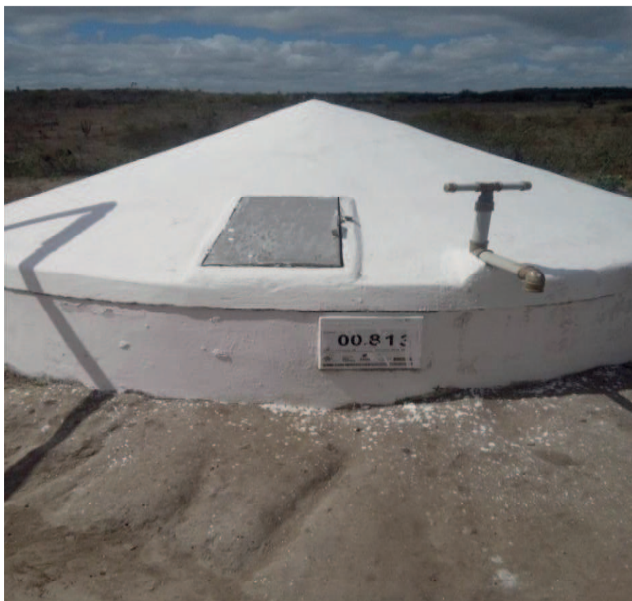
Figura 14: Cisterna com captação de água da chuva.
