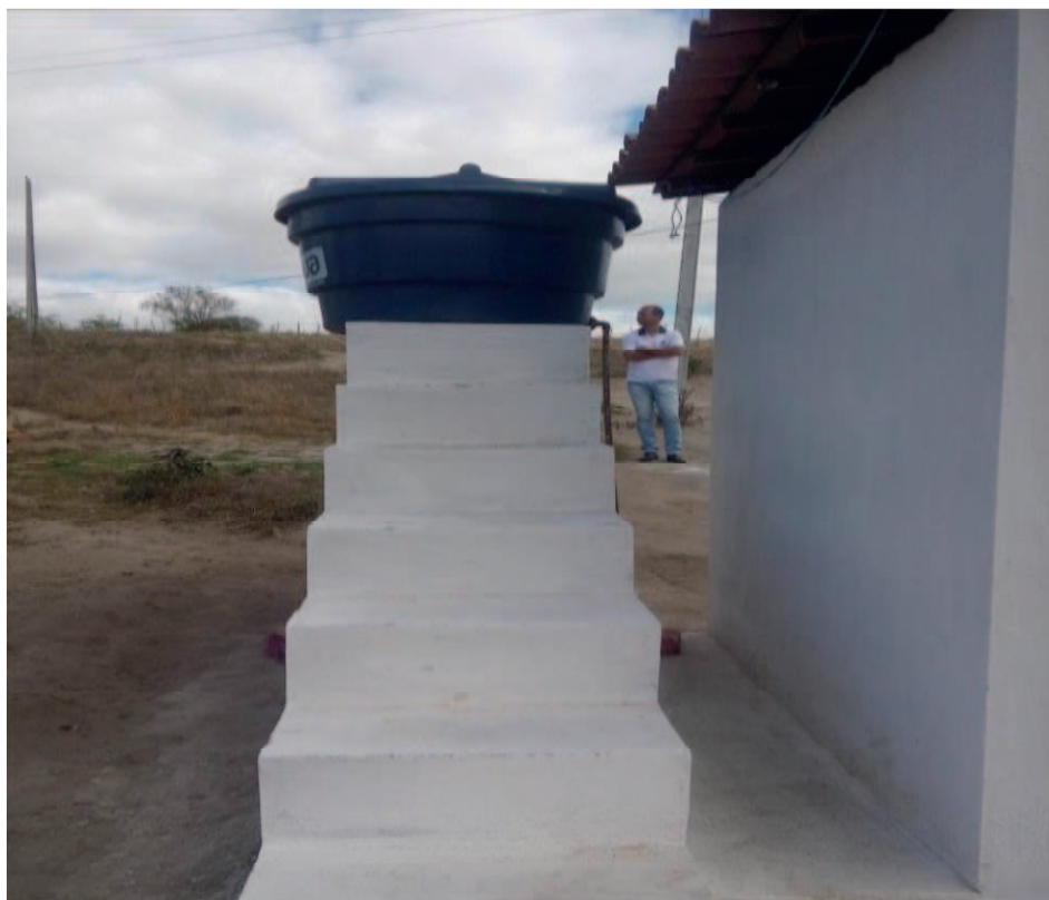
Figura 13: Reservatório semi-elevado para locais sem água encanada.
