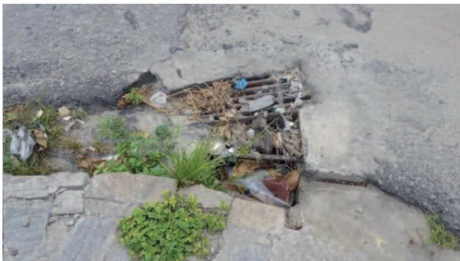
Figura 15: Obstrução por resíduos sólidos
