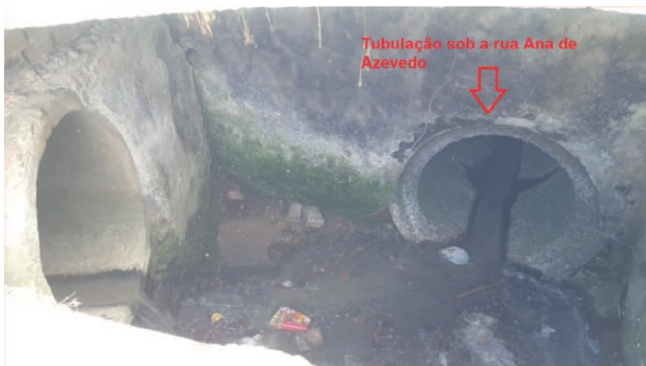
Figura 16: Tubulação principal com menor diâmetro
