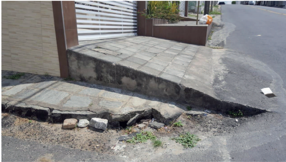
Figura 12: Problema no dimensionamento da boca coletora e obstrução da sarjeta
