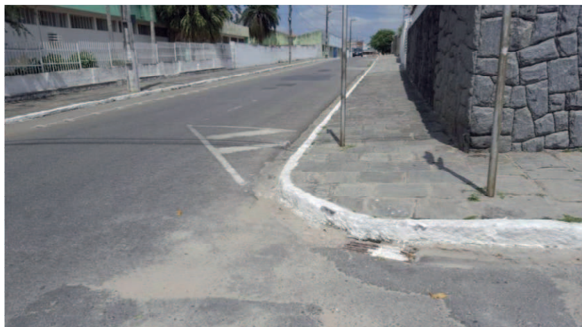
Figura 11: Tipo e localização inadequados das bocas coletoras
