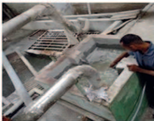
Figura 10 - Reator de lodo ativado e efluente clarificado
