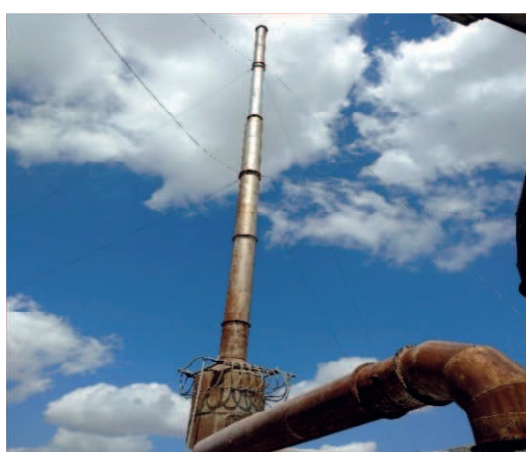
Figura 17 - Lavador de gases com chaminé.
