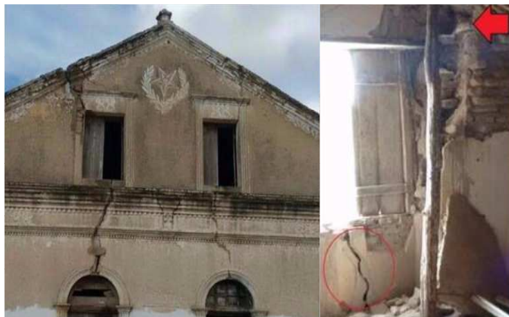
Figura 10- Rachaduras encontradas na fachada principal.
