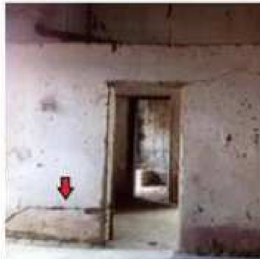
Figura 8- Fissuração por acomodação da fundação
