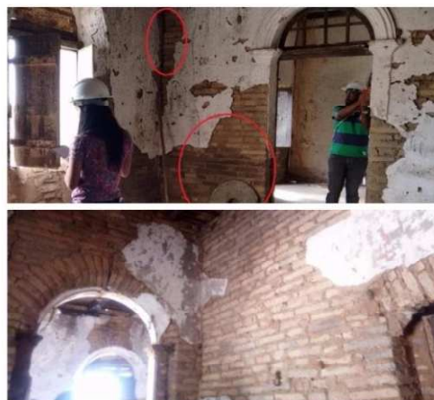
Figura 3- Destacamento de argamassa.
