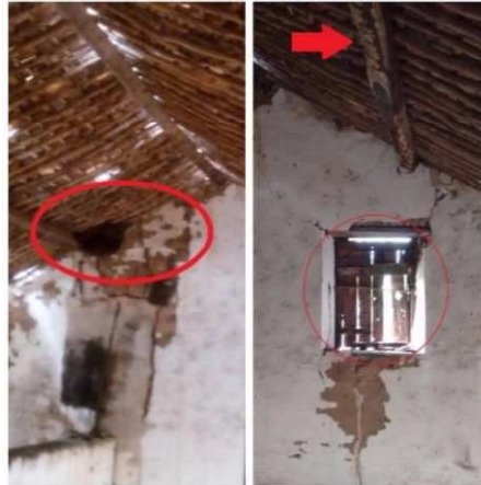
Figura 4 -Degradação do madeiramento no casarão da Fazenda Maquiné.
