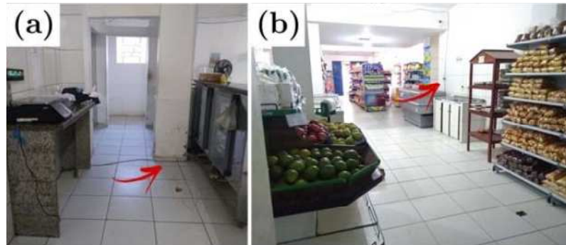
Figura 26 - Presença de extensão para ligar equipamento.
