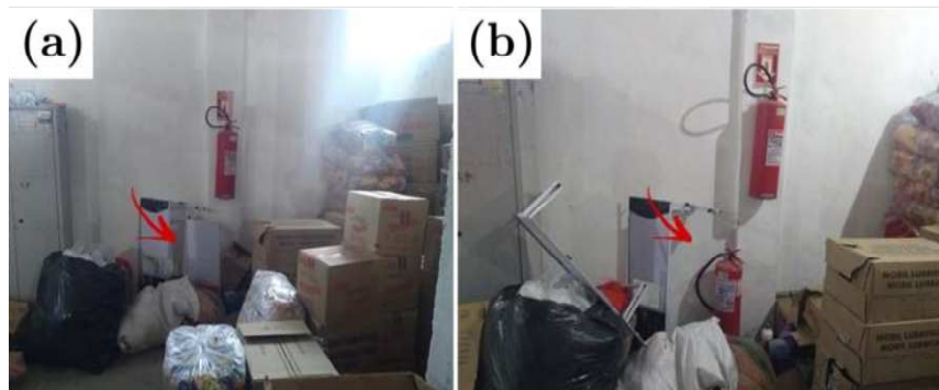
Figura 20 - Extintores presentes no depósito.
