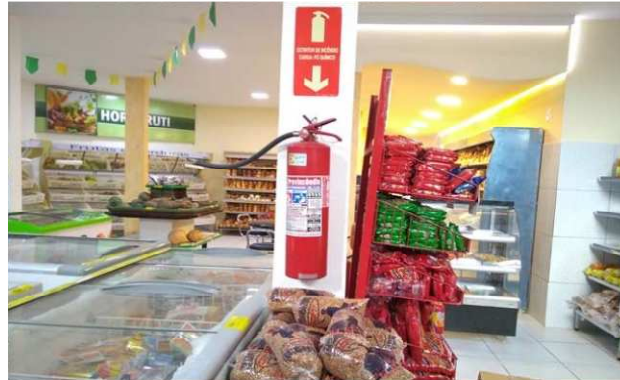
Figura 8 - Extintor de Pó químico.
