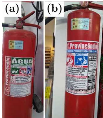
Figura 9 - Extintor certificado pelo INMETRO.
