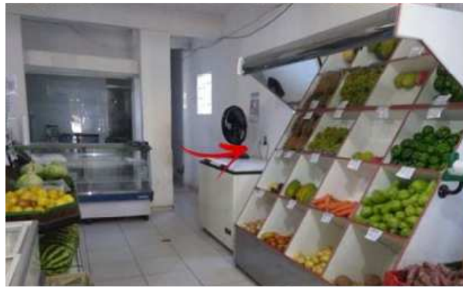
Figura 27 - Presença de Tê em tomada.
