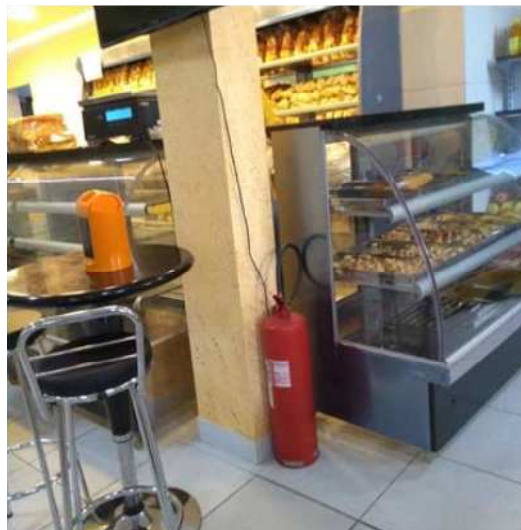
Figura 6 - Extintor de água.
