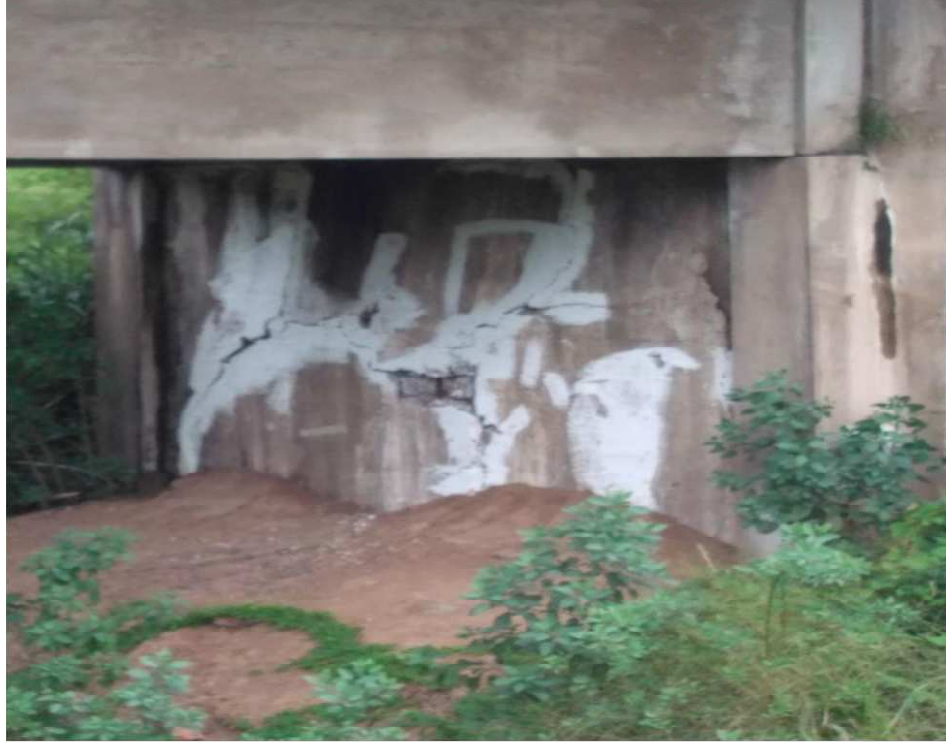
Figura 48- Rachadura no encontro da ponte do Rio Piaba.
