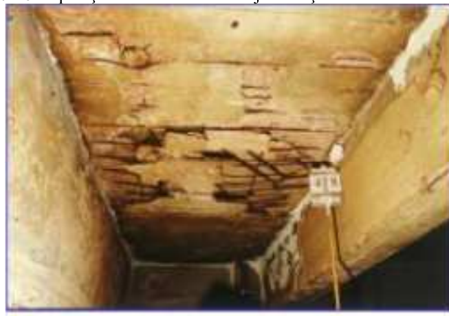
Figura 16 -Exposição da armadura em laje maciça devido um incêndio.
