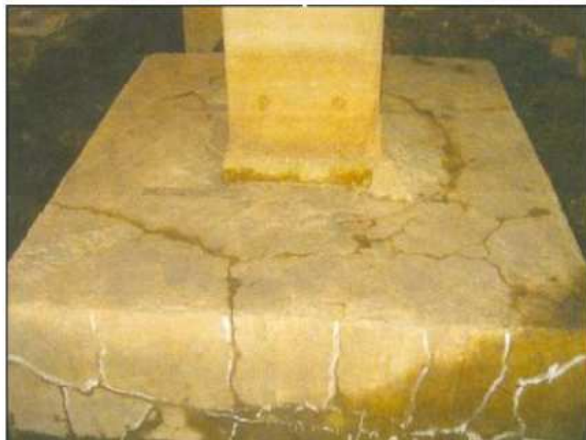
Figura 22- Aspecto visual de uma sapata deteriorada pela reação álcali agregado.
