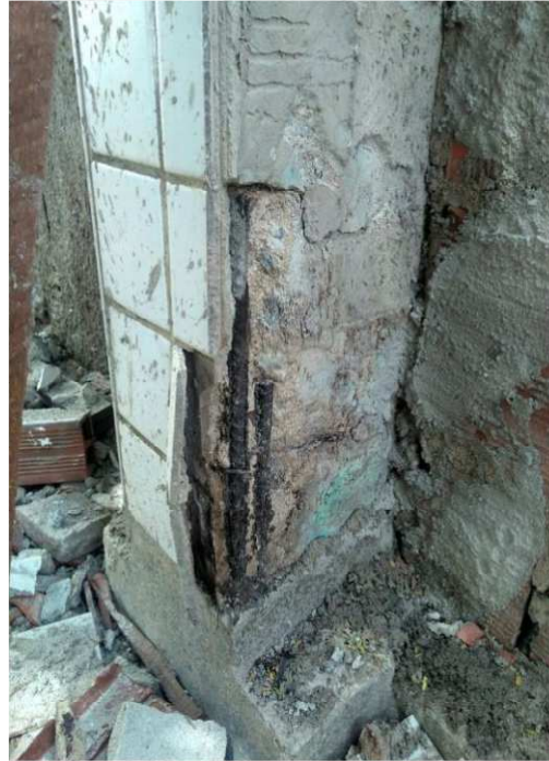
Figura 28 -Pilar com Armadura deteriorada pela corrosão.
