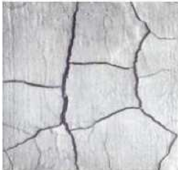
Figura 14- Fissuras Típicas de retração térmica no concreto.
