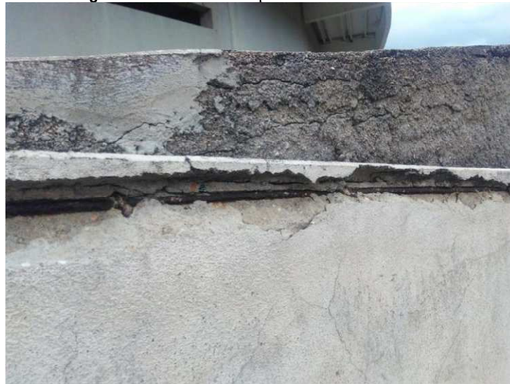
Figura 47- Corrosão em passarela do santuário.
