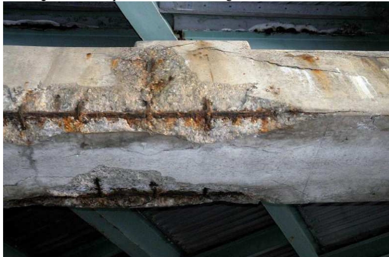
Figura 20- Ataque de cloretos em viga de concreto armado.
