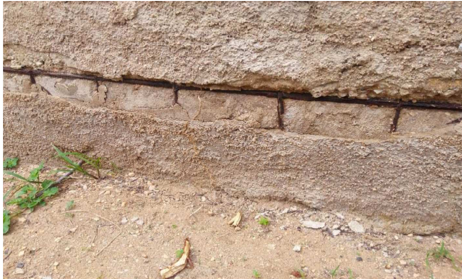
Figura 44- Corrosão ao longo de Viga baldrame do santuário.
