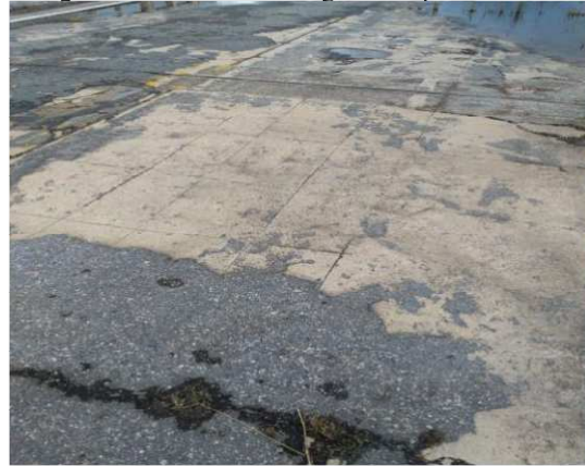
Figura 37 -Pavimento degradado por Abrasão
