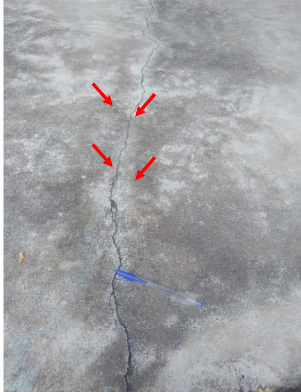
Figura 35- Fissuras causadas pelo Recalque da Estrutura.
