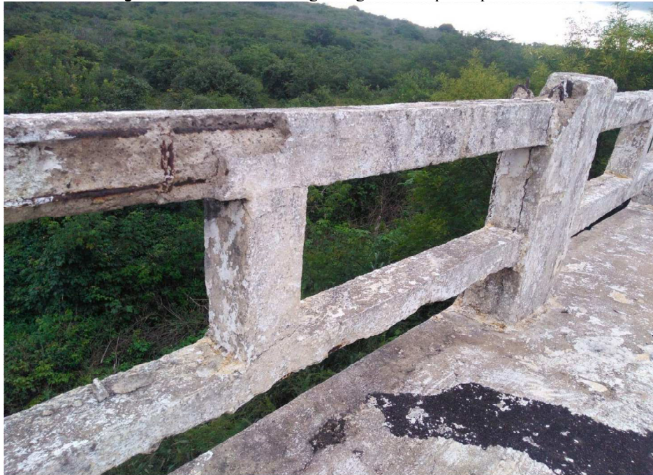
Figura 46- Corrosão ao longo do guarda corpo da ponte.
