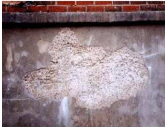
Figura 9- Fragmentação do concreto devido a cristalização nos poros.
