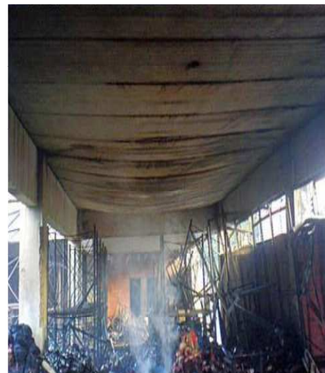
Figura 3- Deformação em laje devido a incêndio.
