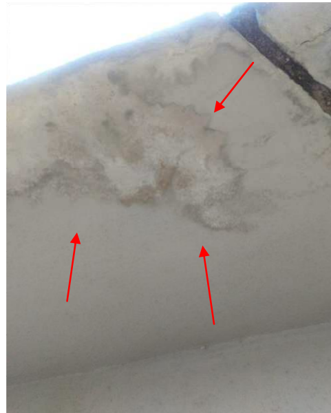
Figura 41 -Eflorescência em Marquise do Santuário.
