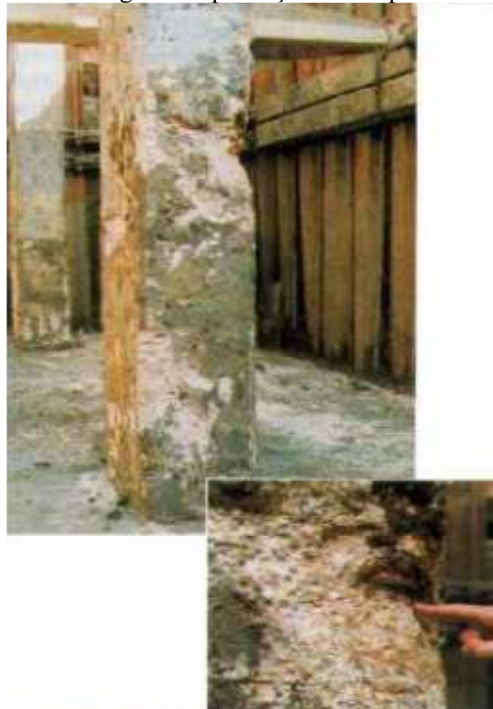
Figura 18- Pilar degradado pela ação de ataque de sulfatos.
