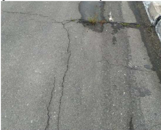
Figura 36 -Pavimento Flexível apresentando fissuras.
