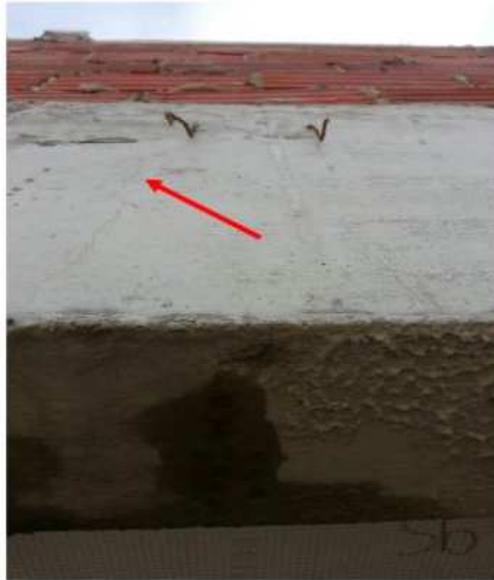
Figura 15- Fissuras causadas pela variação de temperatura.
