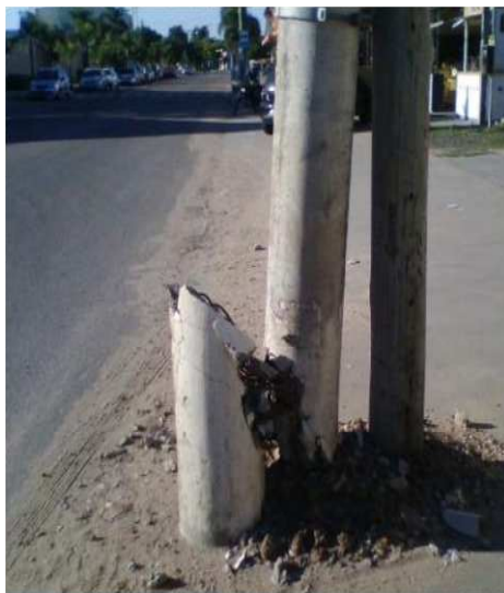
Figura 2 - Poste quebrado pelo choque de veículos.
