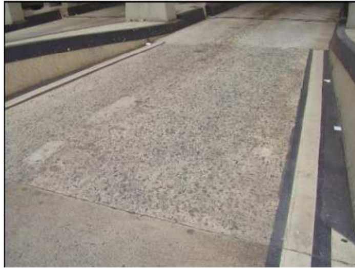
Figura 4- Desgaste por abrasão em piso de concreto.
