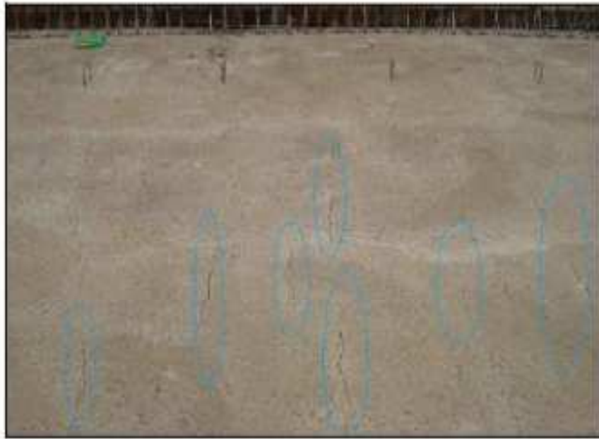
Figura 13- Fissuras devido à retração plástica em laje de concreto
