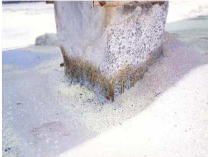
Figura 19- Ataque de ácido sulfúrico em pilar de concreto armado.
