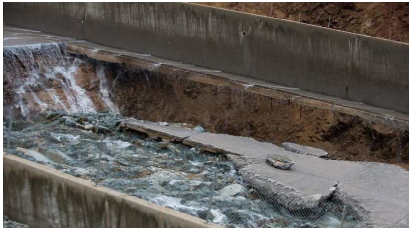
Figura 8- Vista dos danos no canal extravasor da Barragem Oroville
