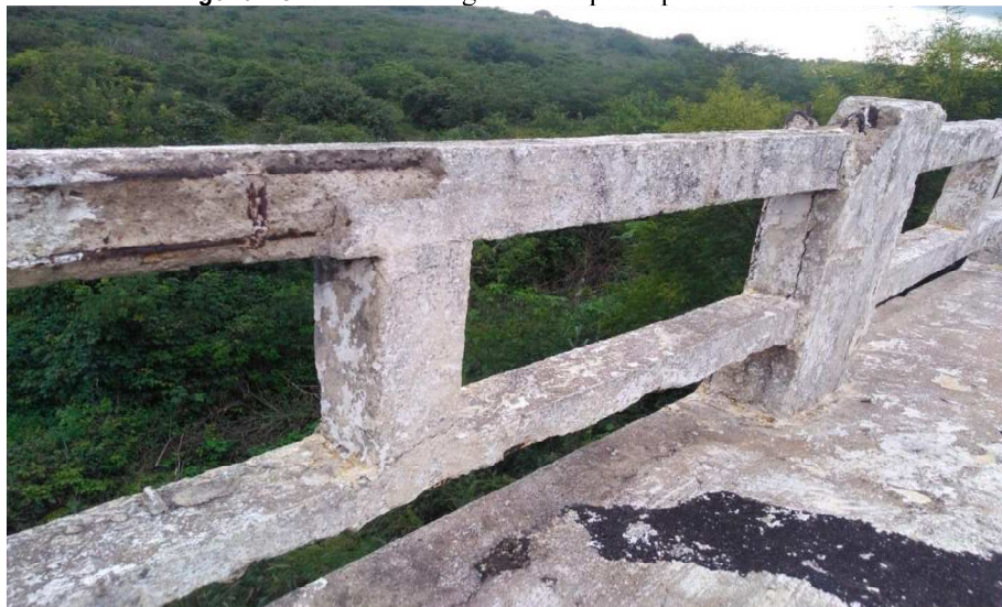
Figura 45- Corrosão em guarda-corpo da ponte.
