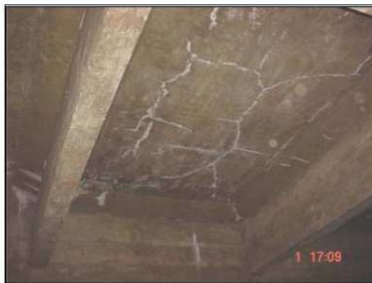
Figura 23- Eflorescência em laje de ponte.
