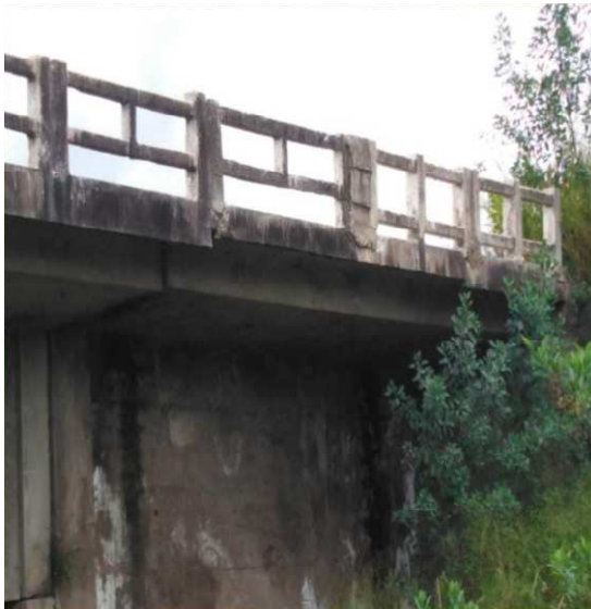
Figura 40 -Eflorescência sob vista lateral da ponte.
