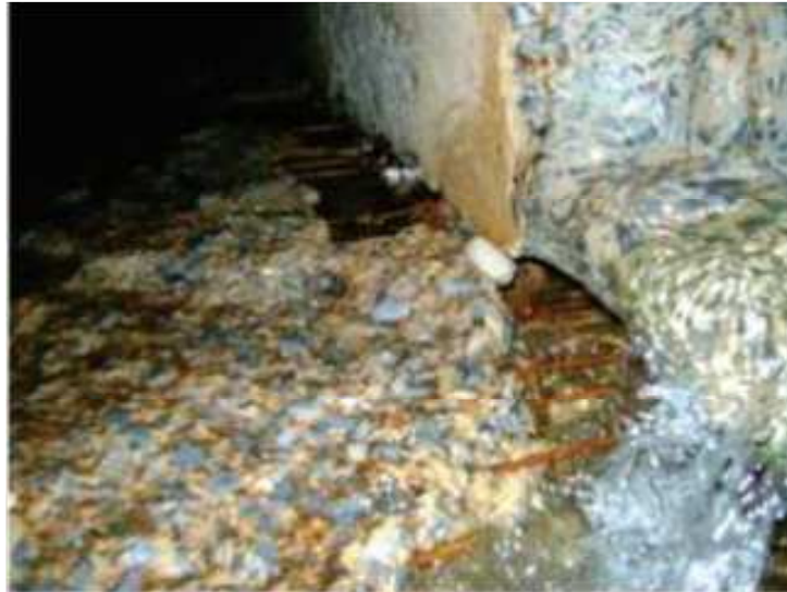
Figura 6 -Aspecto da laje de Piso da galeria de córrego da serra devido ao processo de erosão.
