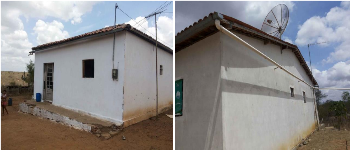
Figura 11: Problemas arquitetônicos observados nas residências no Pequeno Richard.
