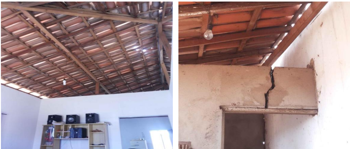
Figura 12: Residências localizadas no assentamento Pequeno Richard apresentando ausência de forro e presença de fissuras nas paredes.
