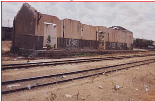
Figura 21: Antiga estação ferroviária federal em processo de desmoronamento
