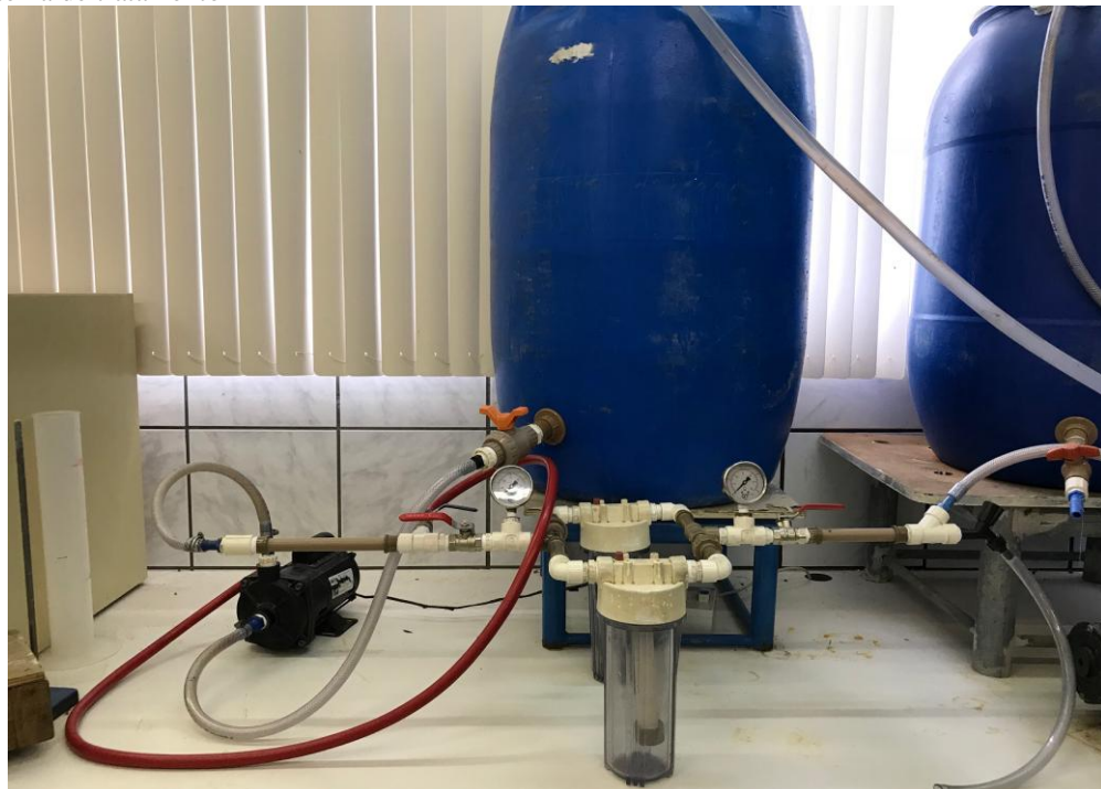
Figura 3: Sistema de tratamento
