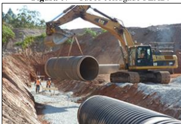
Figura 07 – Tubos corrugado PEAD.
