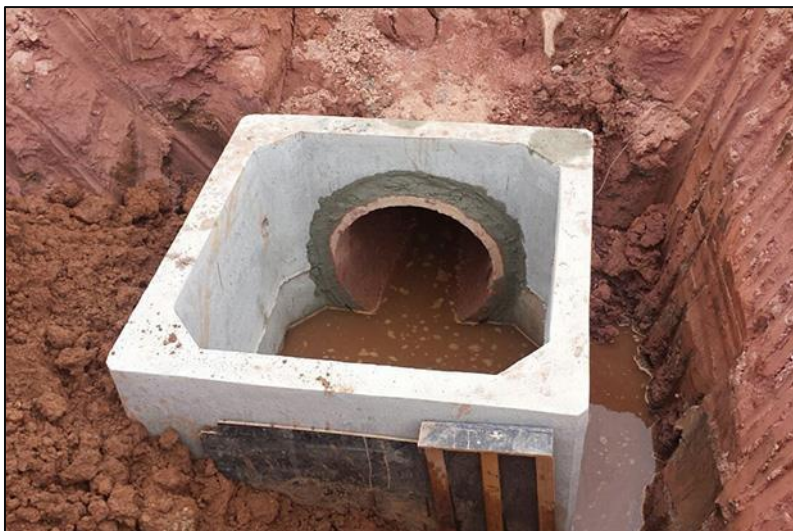
Figura 01- Elemento poço de visita.
