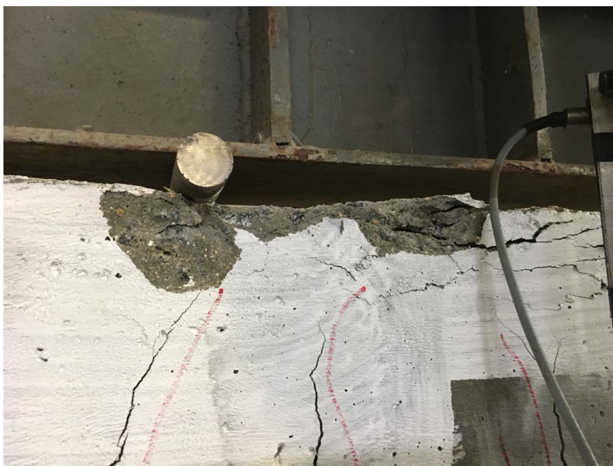
Figura 32 - Esmagamento do concreto na região comprimida.
