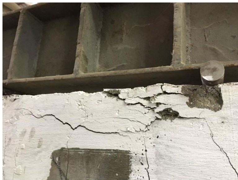
Figura 26 - Região de esmagamento da viga.
