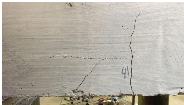
Figura 34 - Fissura horizontal na região das fibras tracionadas na viga mista de seção pequena.
