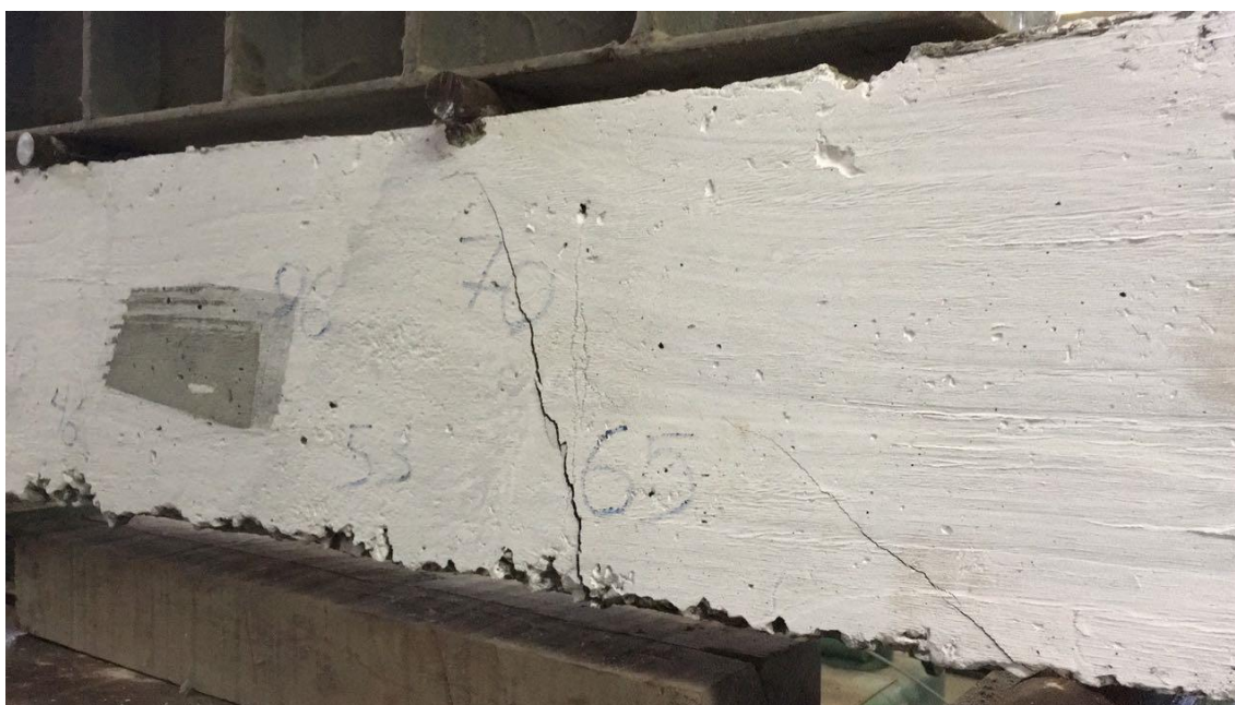
Figura 35 - Fissura inclinada na viga com reforço de seção média.
