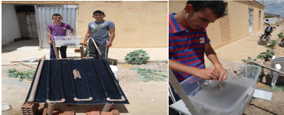
Figura 2: Instalação de um aquecedor solar para obtenção de água quente em um reservatório
