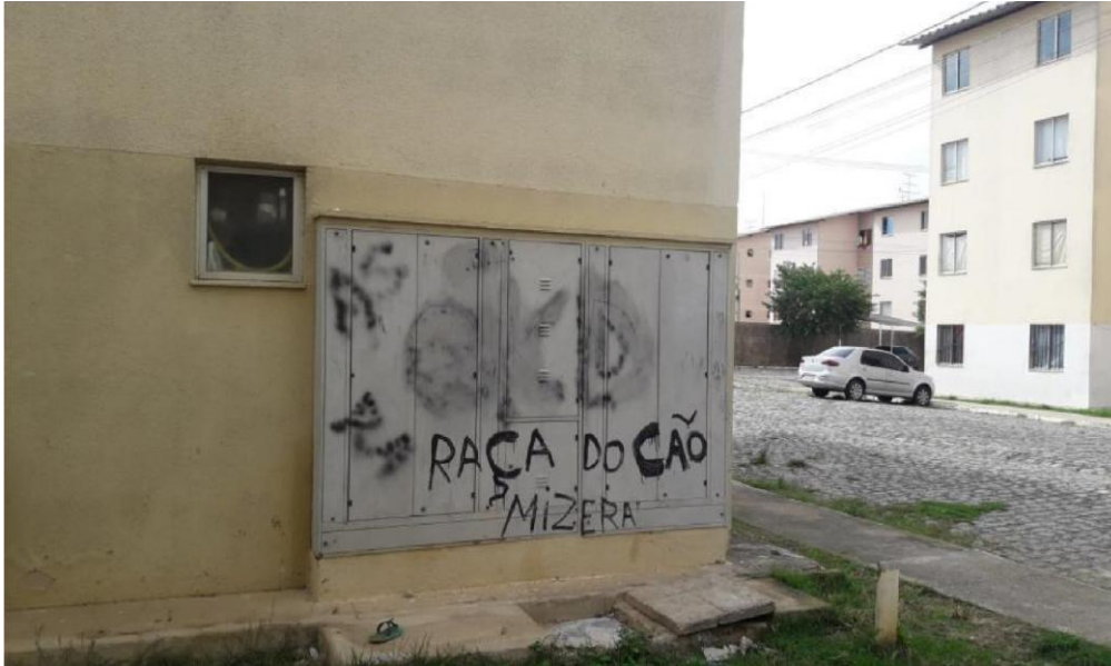
Figura 3 - Pichação em local onde é armazenado quadros de energia.
