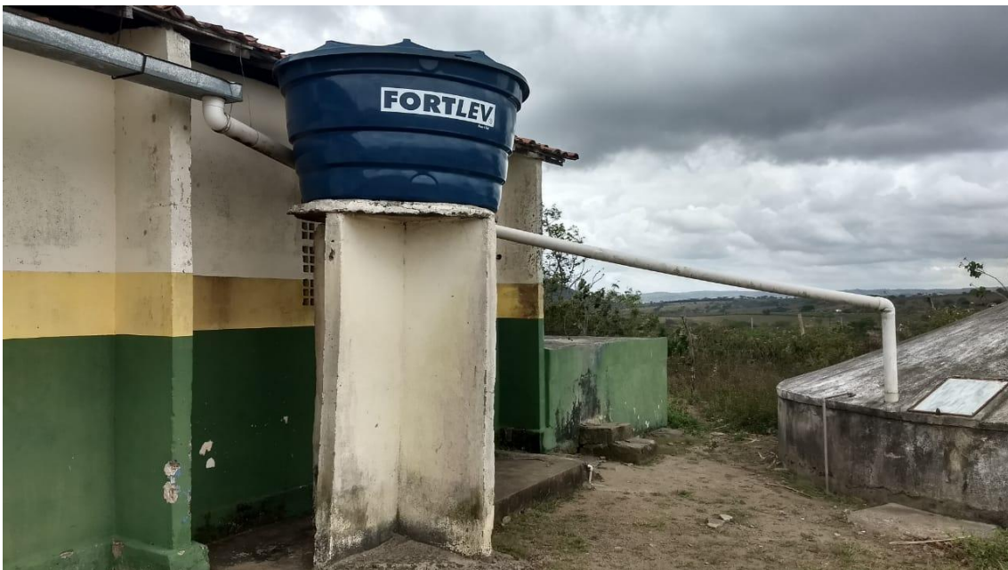
Fotografia 14 – Caixa de Água para a Distribuição de água na Escola do Assentamento Gangungo
