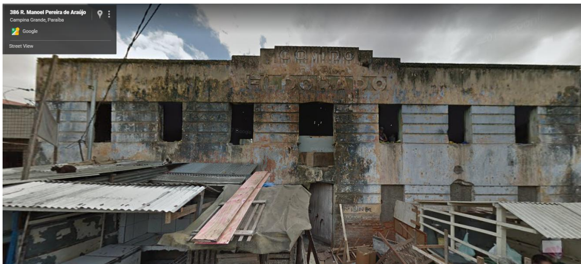
Figura 10 – Fachada do cassino El Dorado ainda completa, mas apresentando o descaso em sua estrutura.
