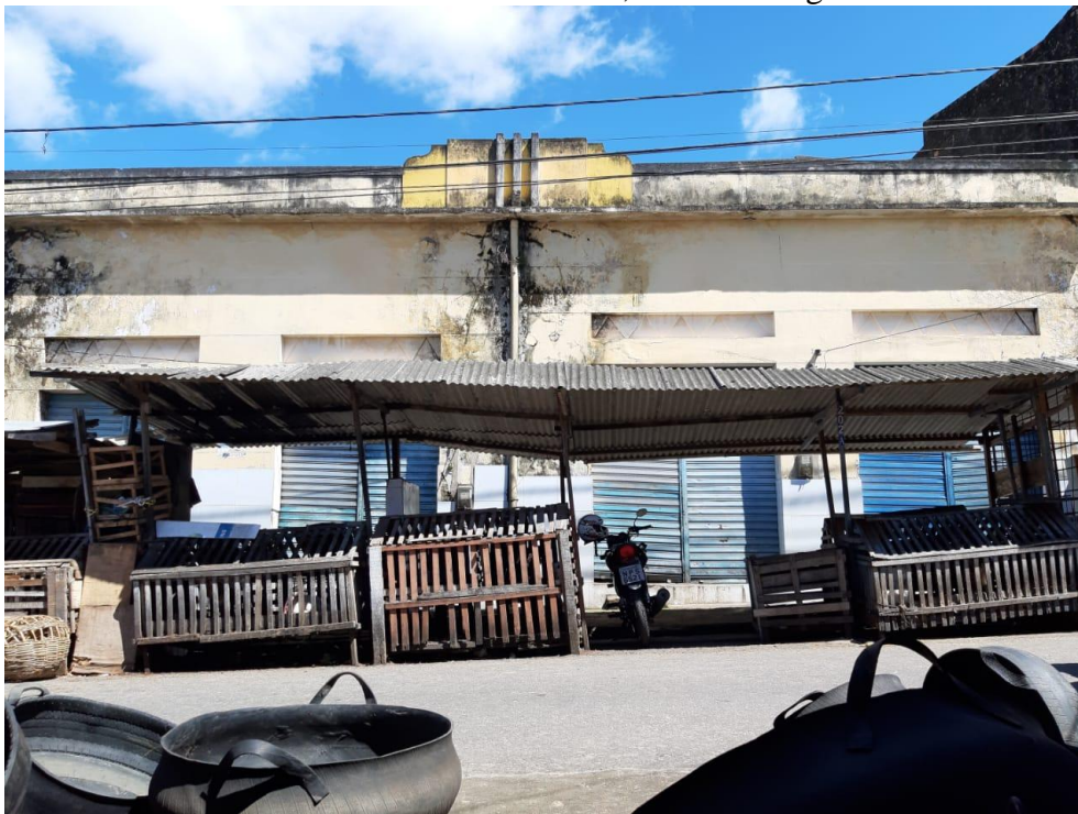
Fotografia 20 - Edificação localizada na Rua Manoel Pereira de Araújo, n° 405, encoberta por bancos de madeira com telhados de amianto, na feira de galinha.
