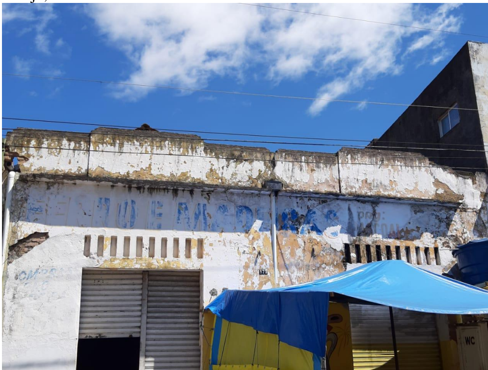
Fotografia 21 - Fachada com traços de abandono, localizada na Rua Manoel Pereira de Araújo, n° 475.
