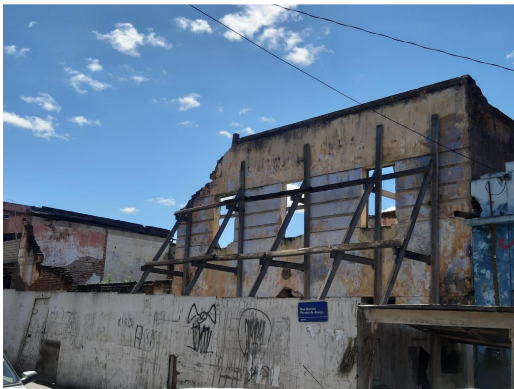
Fotografia 09 - Parte da fachada do Cassino El Dourado sustentada por vigas.
