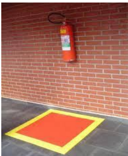
Figura 8: Sinalização de solo para equipamentos de combate a incêndio.
