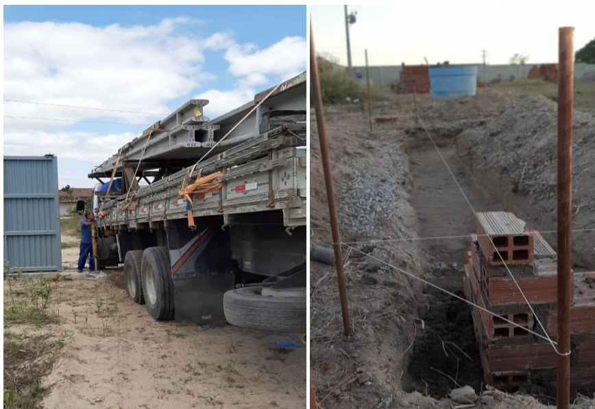
Figura 16 – Preparação do canteiro de obras e locação das valas e materiais ao fundo
