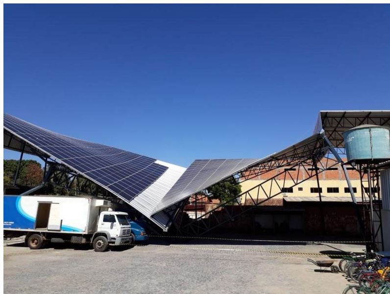
Figura 11 - Colapso estrutural proveniente da sobrecarga dos módulos
