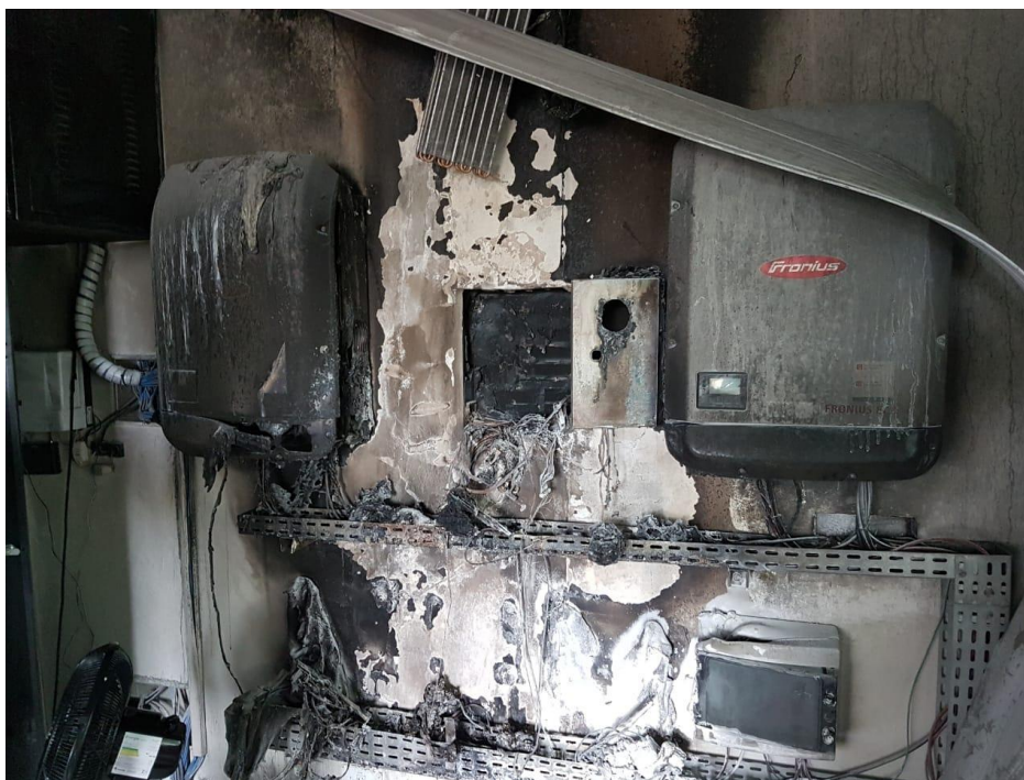
Figura 10 - Incêndio provocado por um gerador solar fotovoltaico
