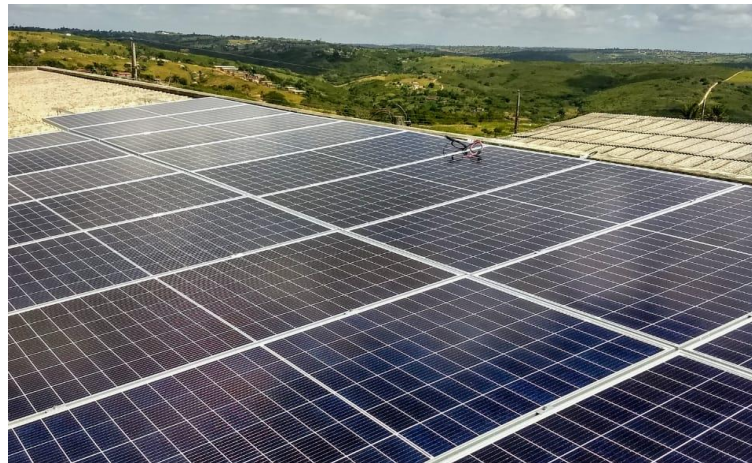
Figura 4 - Módulos fotovoltaicos instalados sobre telhado
