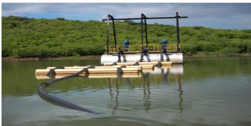
Figura 2. Ponto de captação da água bruta localizado no rio Paraibinha - Itatuba/Paraíba.
