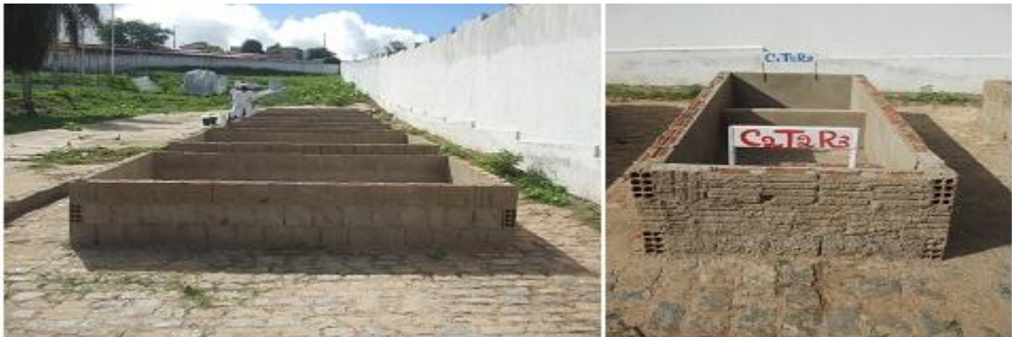
Figura 1: Fotos do Sistema de Tratamento Descentralizado de Resíduos Sólidos Orgânicos Domiciliares instalado no Bairro de Santa Rosa. Campina Grande-PB, maio de 2010, sem cobertura (SILVA et al. , 2010).
