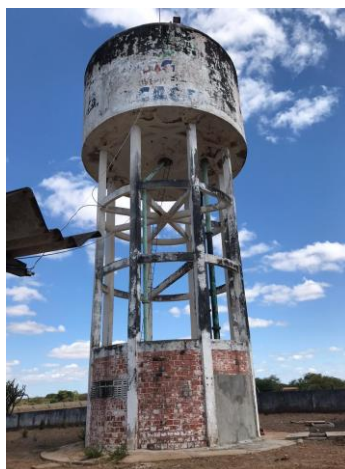
Figura 15 - Reservatório do SAA de São João do Rio do Peixe-PB
