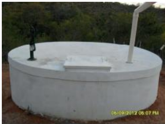
Figura 3 – Cisterna para reaproveitamento de água pluvial
