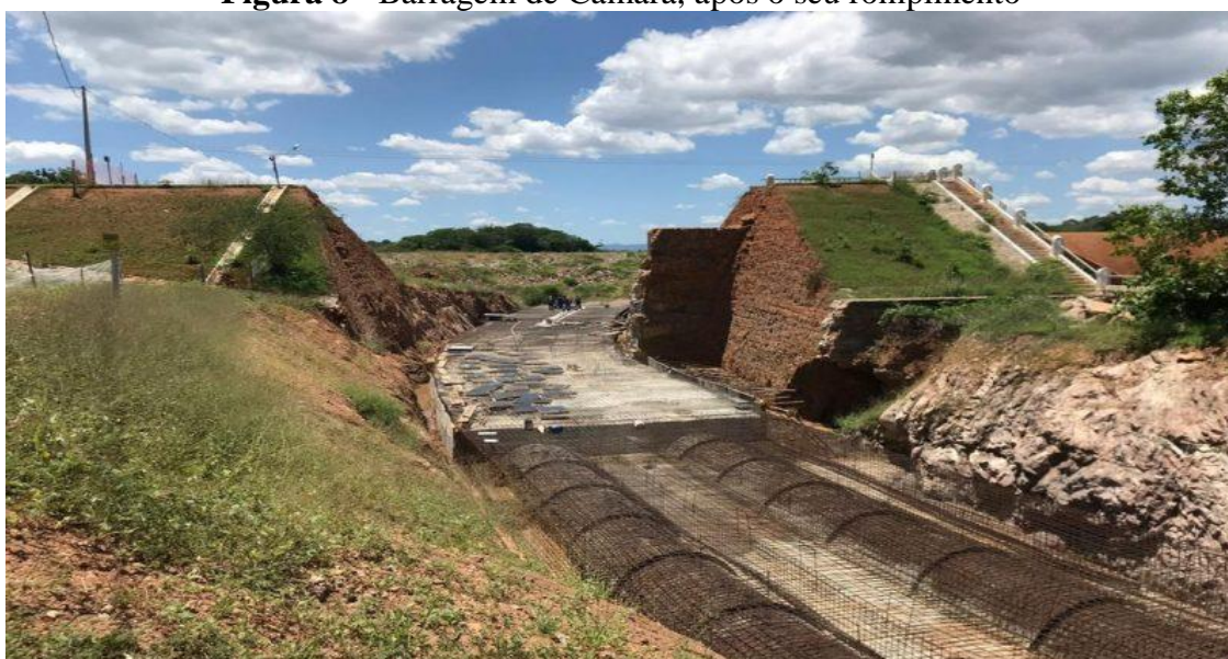
Figura 8 - Barragem de Camará, após o seu rompimento
