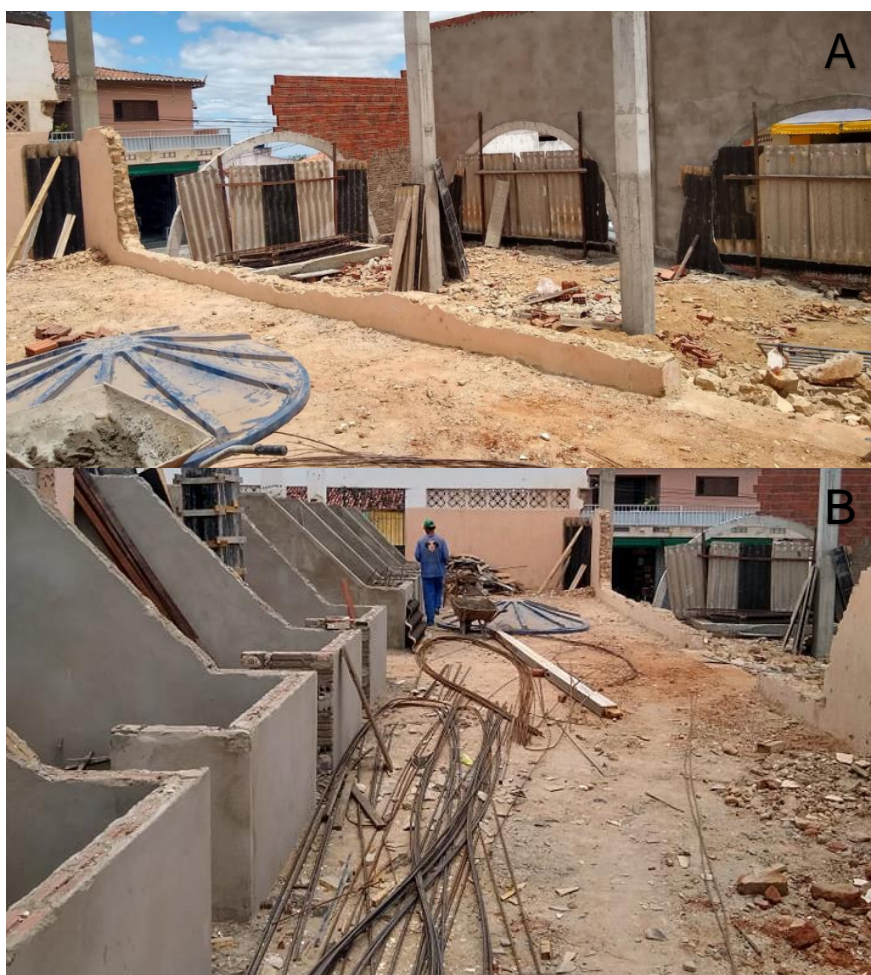
Figura 08 – Situação do canteiro. A: Desorganização. B: Falta da utilização de EPI's
