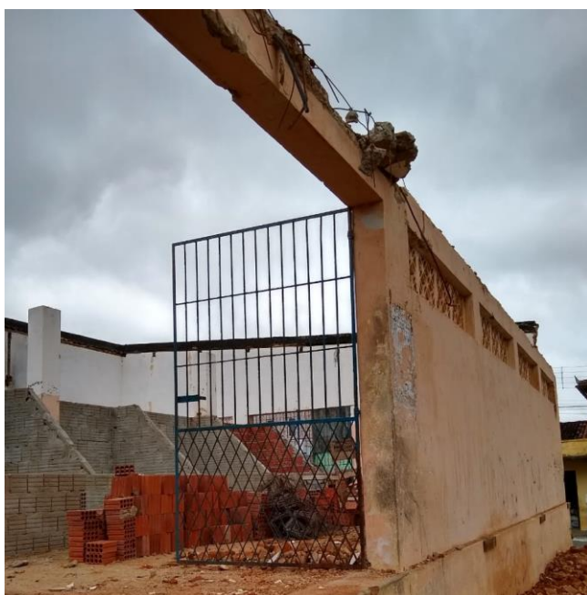
Figura 07 – Riscos eminentes encontrados na obra
