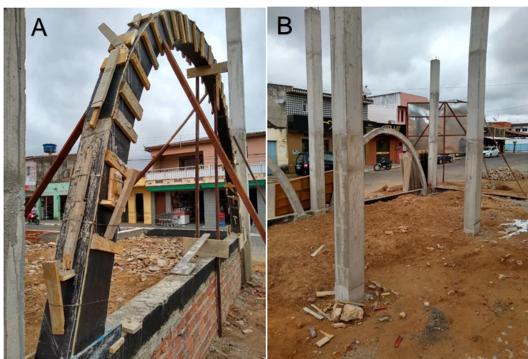
Figura 06 – Análise da Obra. A: Arcos frontais após concretagem e colocação da forma. B: Pilares da entrada já executados
