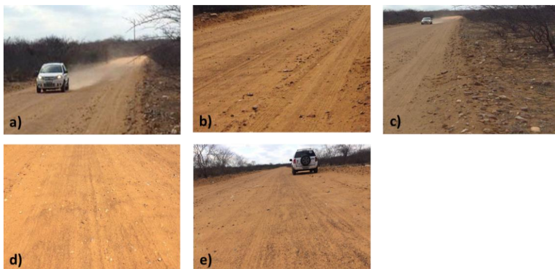
Figura 16 – Defeitos da unidade amostral 1: a) Poeira; b) Segregação de agregados; c) Ausência das valas de drenagem lateral; d) Corrugações; e) Seção transversal inadequada.
