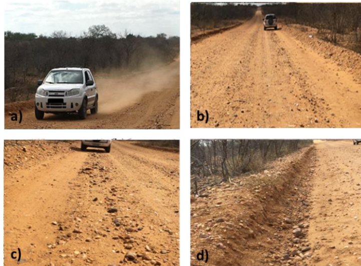
Figura 20 – Defeitos da unidade amostral 5: a) Poeira; b) Seção transversal inadequada; c) Segregação de agregado; d) Ausência das valas de drenagem lateral.
