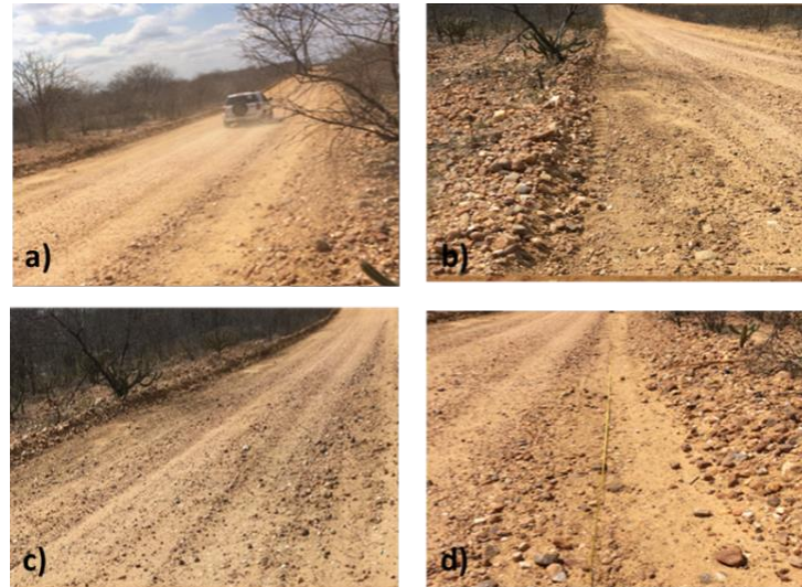
Figura 17 – Defeitos da unidade amostral 2: a) Poeira; b) Ausência das valas de drenagem lateral; c) Seção transversal inadequada; d) Segregação de agregados.
