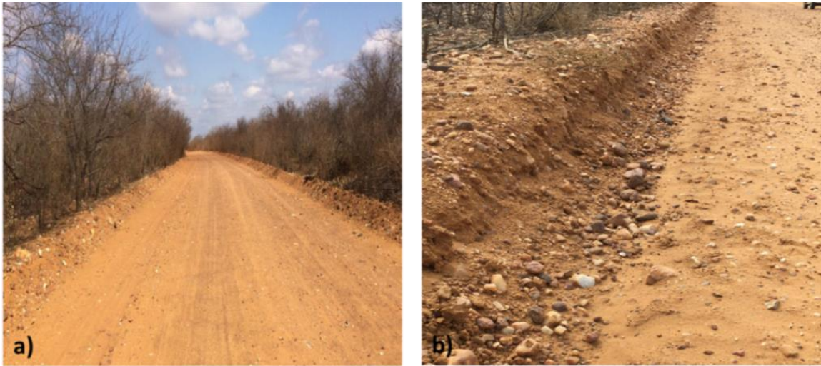
Figura 22 - Consequências da execução inadequada da manutenção: a) Materiais retirados durante o patrolamento inadequado acumulam-se em forma de leiras nas laterais da pista; b) Encaixe do greide devido ao rebaixamento do perfil longitudinal da estrada.
