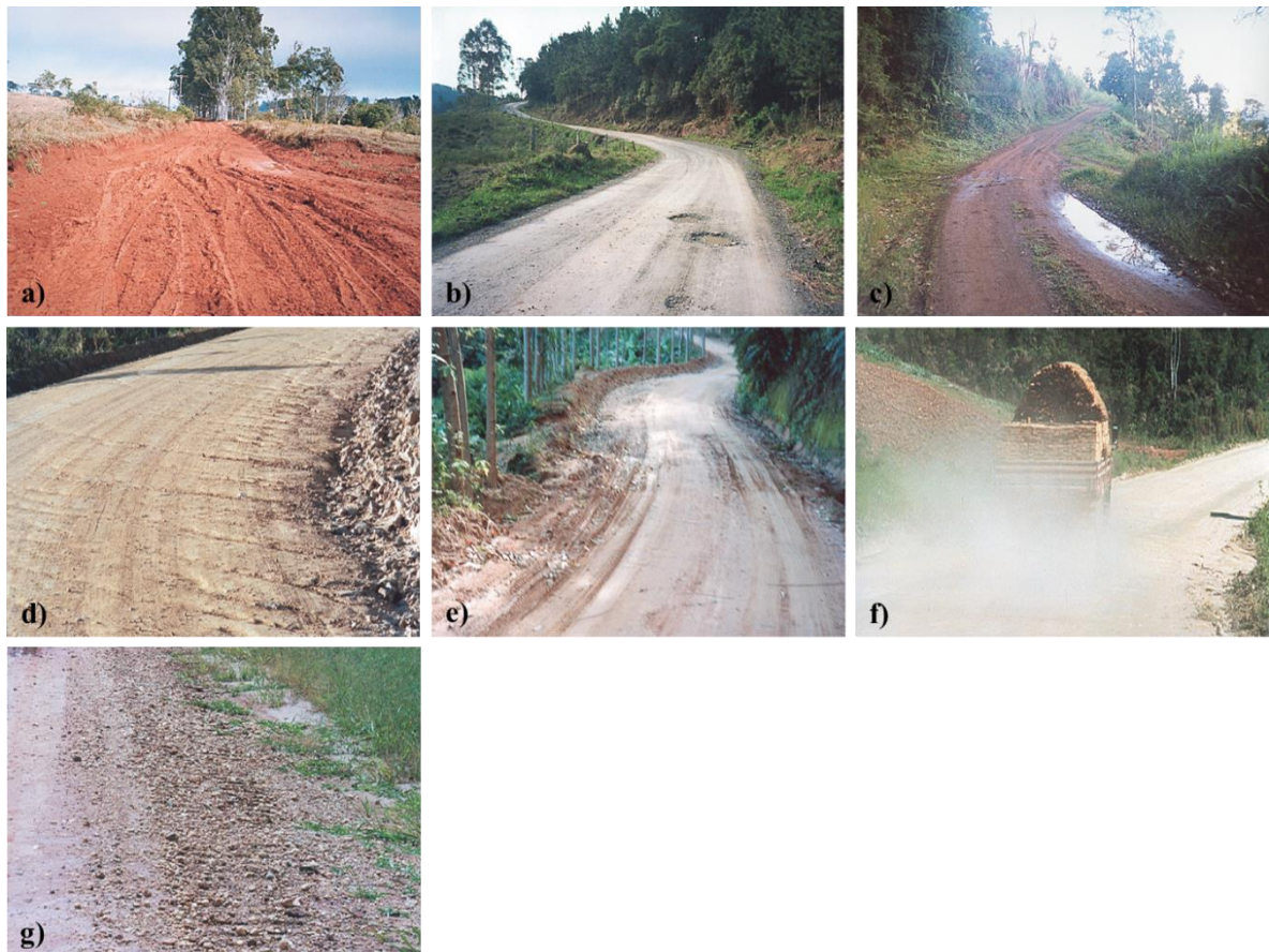
Figura 1- Principais defeitos das estradas não pavimentadas: a) Seção transversal inadequada; b) Buracos; c) Drenagem lateral inadequada; d) Corrugações; e) Trilha de rodas; f) Poeira; g) Segregação de agregados.
