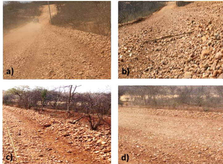
Figura 19 – Defeitos da unidade amostral 4: a) Poeira; b) Seção transversal inadequada; c) Ausência das valas de drenagem lateral; d) Segregação de agregados.
