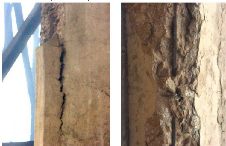
a) Lascamento de canto (“ sloughing ”) b) Lascamento explosivo (“ explosive spalling ”)
