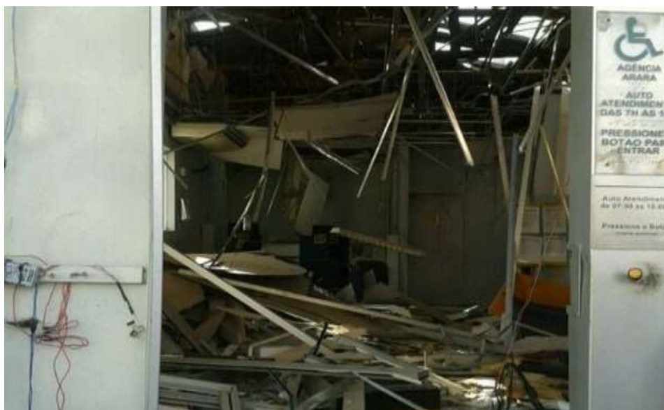
Figura 1 - Agência do BB de Arara-PB após a explosão
