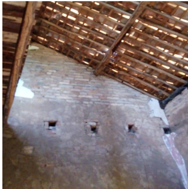
Figura 21: Desplacamento de reboco em alvenaria 2
