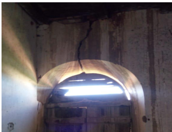
Figura 18: Trinca em abertura de esquadria 4
