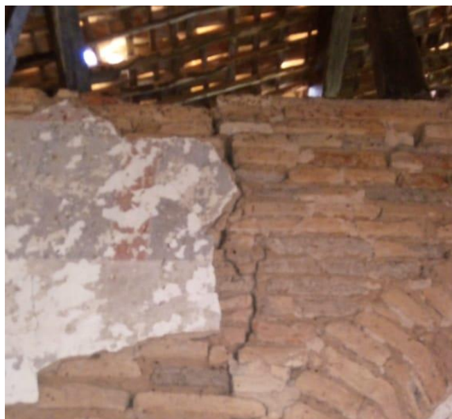
Figura 14: Trincas verticais em alvenaria 2
