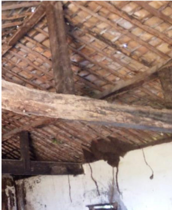
Figura 25: Presença de cupins nas estruturas de madeira 1
