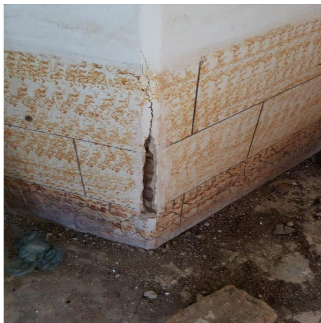
Figura 22: Desplacimento de revestimento em alvenaria 3
