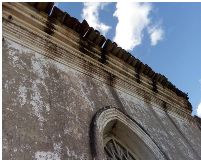
Figura 24: Manchas causadas por umidade 2
