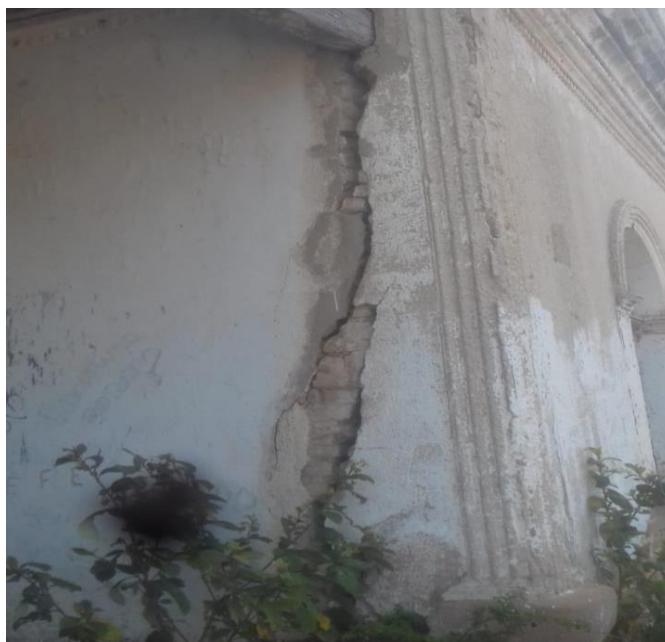
Figura 8: Trinca vertical em canto da alvenaria
