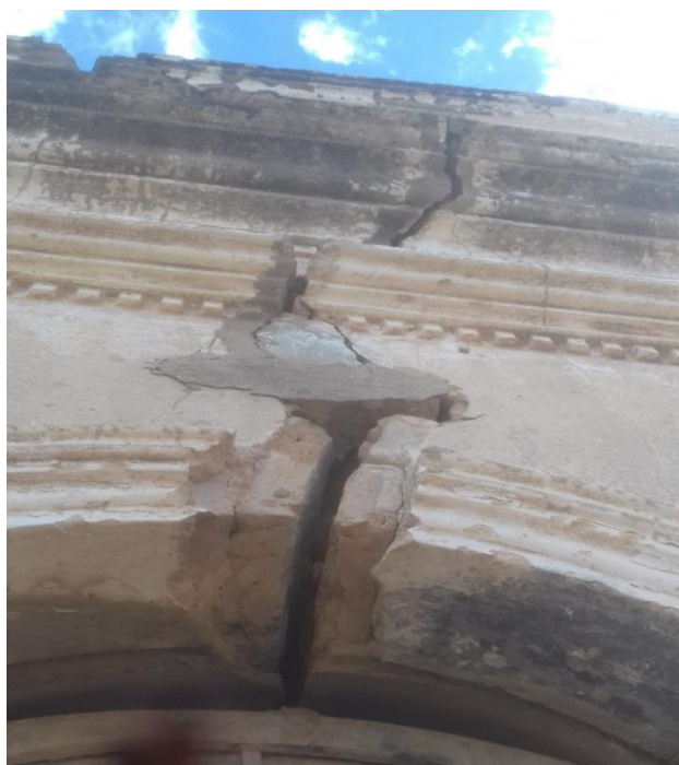
Figura 16: Trinca em abertura de esquadria 2
