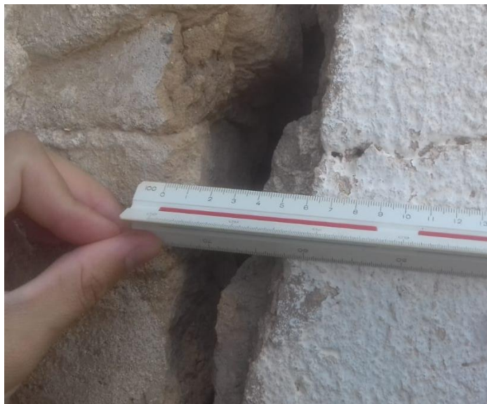
Figura 9: Trinca com mais de 3 cm de abertura em alvenaria
