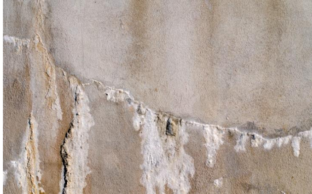
Figura 6: Eflorescência causada por depósitos salinos na superfície de alvenaria
