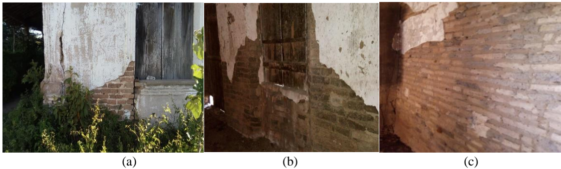
Figura 20: Desplacamento de reboco em alvenaria 1
