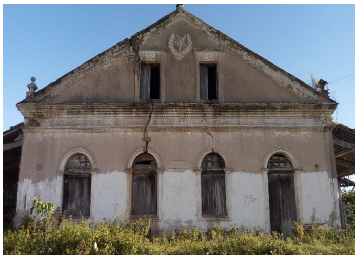
Figura 15: Trinca em abertura de esquadria 1
