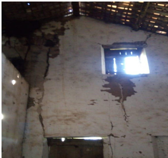
Figura 17: Trinca em abertura de esquadria 3
