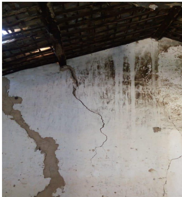
Figura 12: Trinca causada por compressão na alvenaria 2
