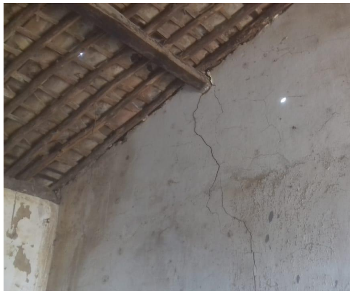
Figura 11: Trinca causada por compressão na alvenaria 1
