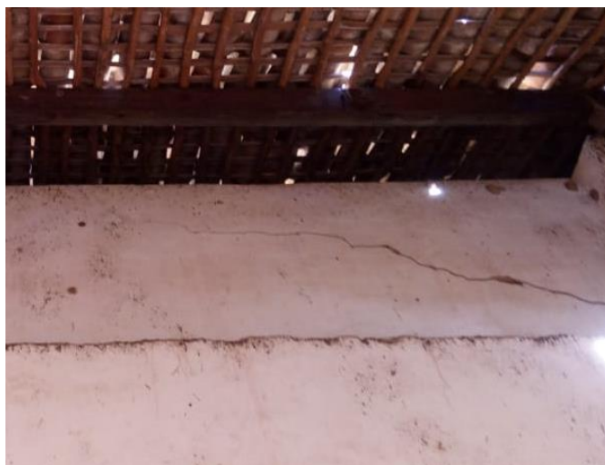
Figura 13: Trincas diagonais em alvenaria 1
