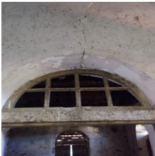
Figura 19: Trinca em abertura de esquadria 5
