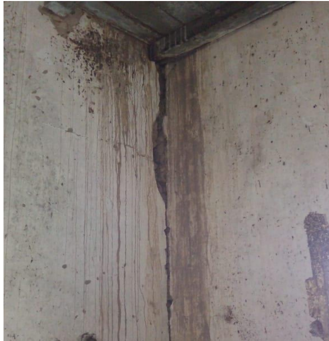
Figura 10: Trinca em canto da alvenaria
