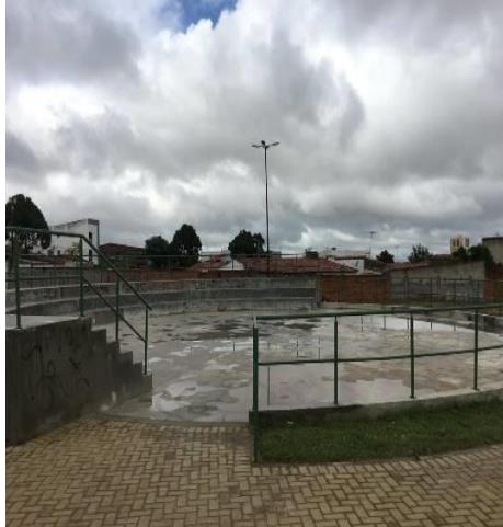
Figura 14: Pista de Skate não concluída.
