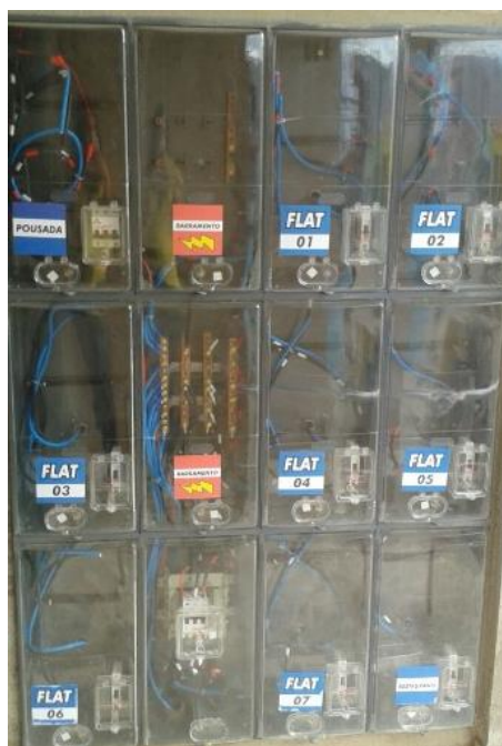
Figura 08 – Quadro de energia do prédio.
