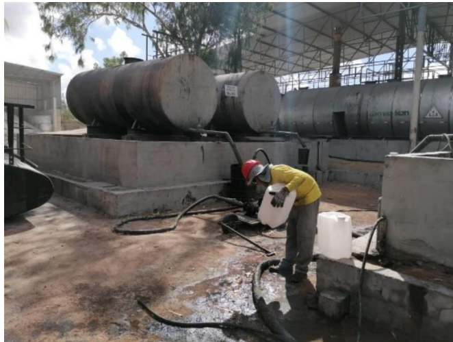
Figura 04: Tanques de armazenamento de emulsão asfáltica.
