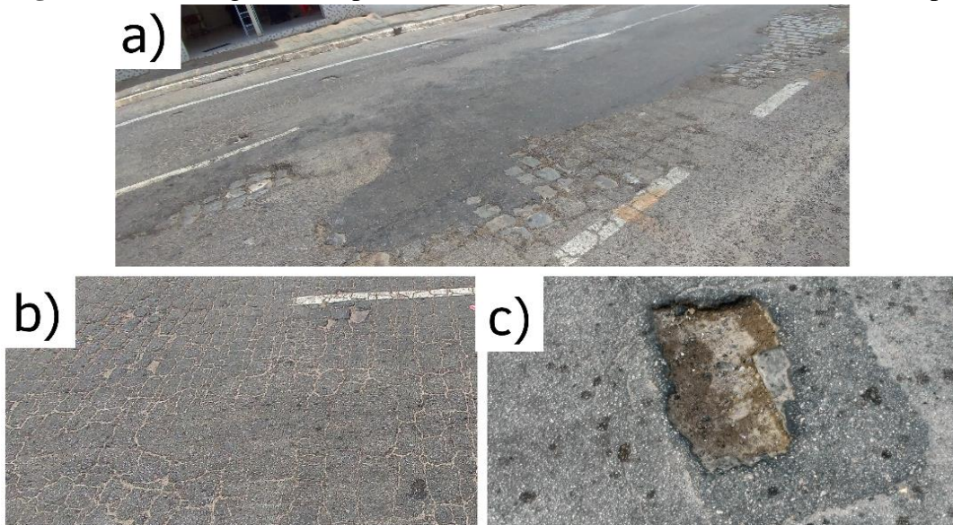
Figura 10 – a) Desgaste com placas; b) Trinca em bloco com e sem erosão; c) placa
