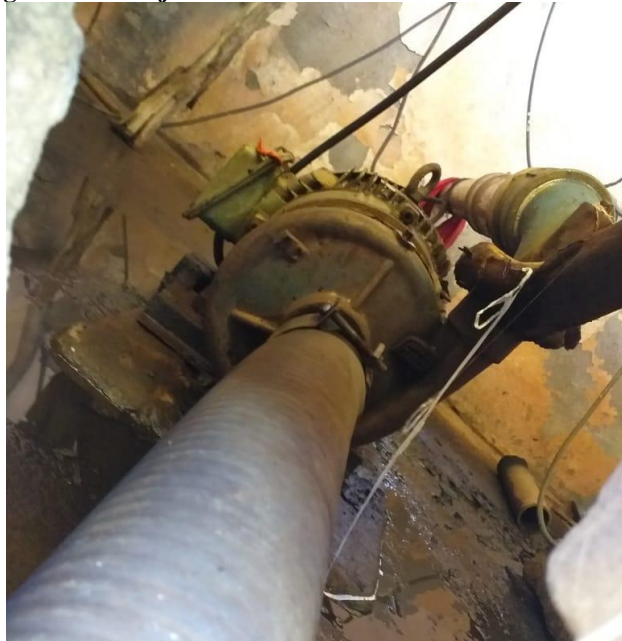
Figura 14 - Conjunto motobomba da adutora do manancial
