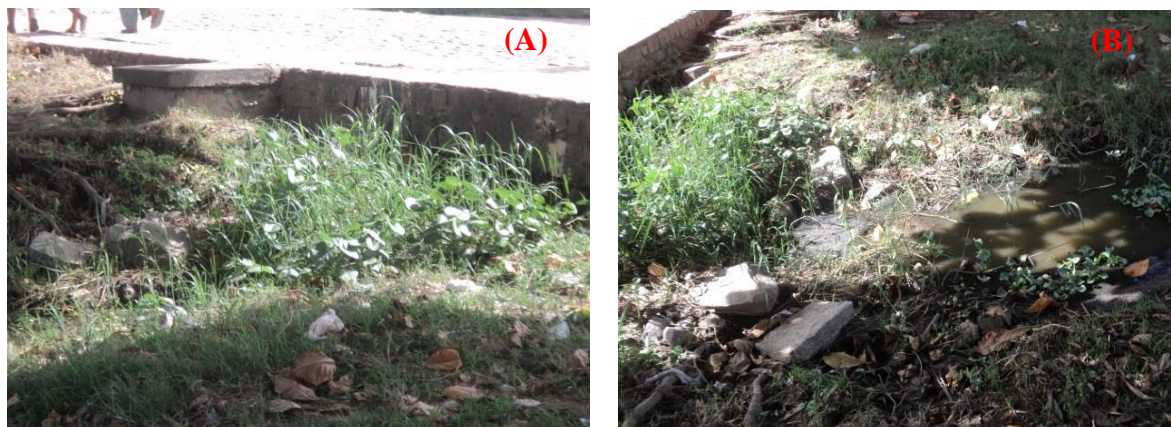
Figura 17 – (A) Caixa de esgoto e esgoto superficial (a céu aberto) e (B) Esgoto a céu aberto.
