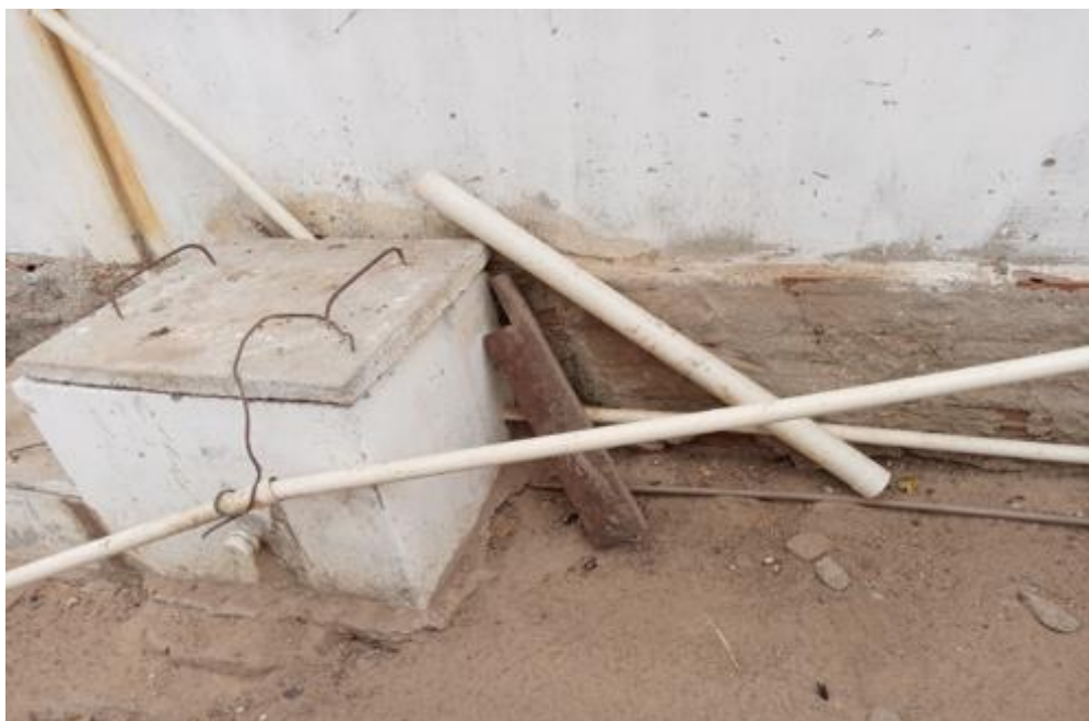
Figura 14- Caixa de gordura do sistema Bioágua.
