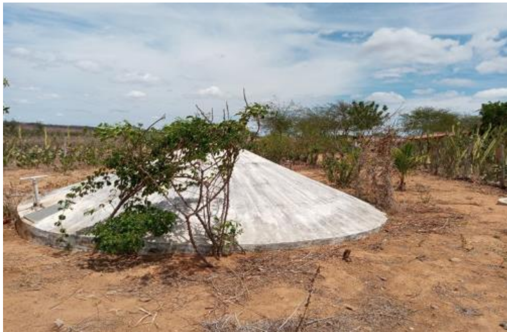
Figura 3- Cisterna usada na captação da água da chuva no assentamento São Domingos no município de Cubati - PB.
