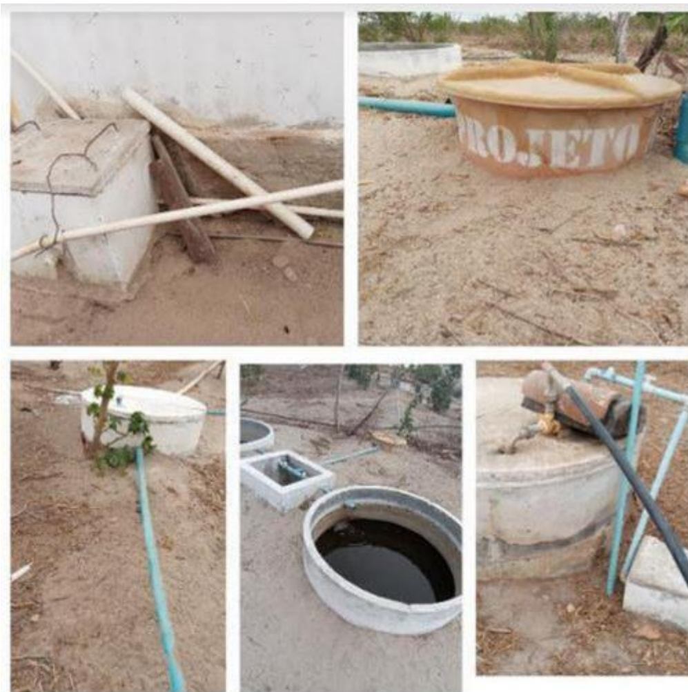
1-Caixa de gordura; 2-Tanque de equalização; 3- Reservatório; 4- Lagoas de polimento; 5- Motobomba.
