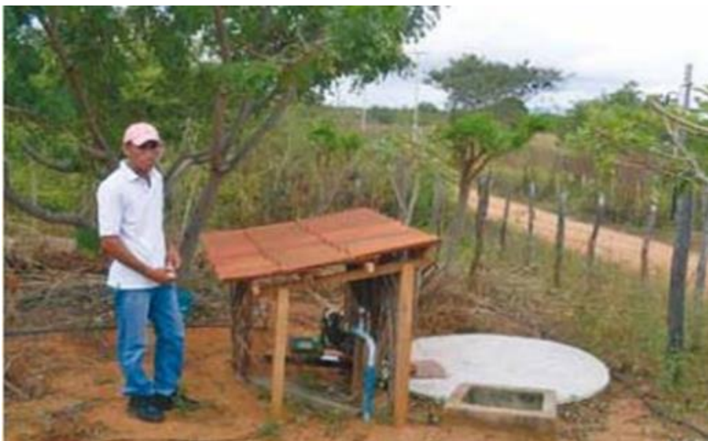
Figura 6-Tanque de reuso com eletrobomba.
