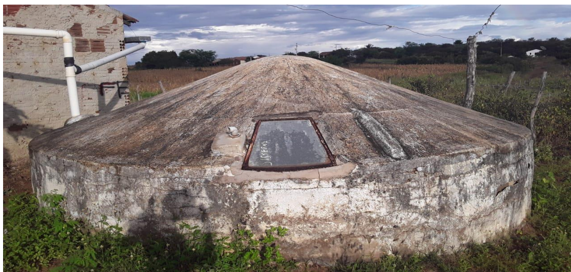
Figura 06: Cisternas de placas na comunidade Olho D'Água Livramento /PB
