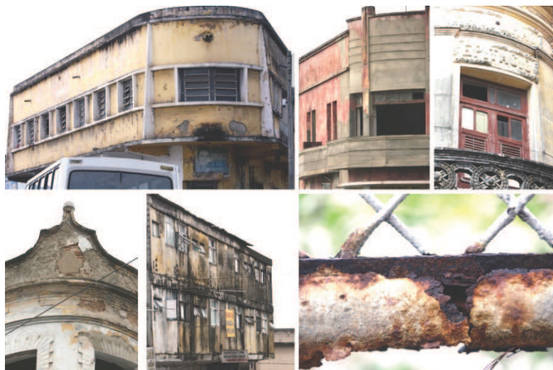
Figura N° 24: Prédios em degradação em Campina Grande
