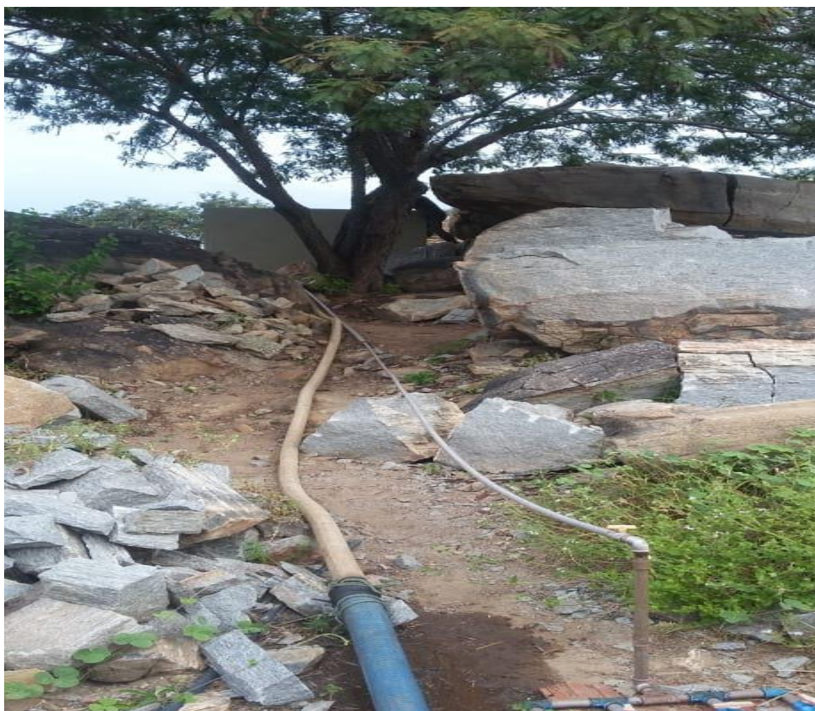
Figura 08: Sistema de encanação de água direcionadas as casas do Sítio Farias. Fonte: A autora (julho/2021).
