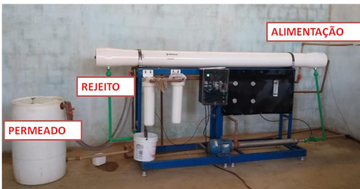
Figura 5 – Sistema de Dessalinização via Osmose Inversa
