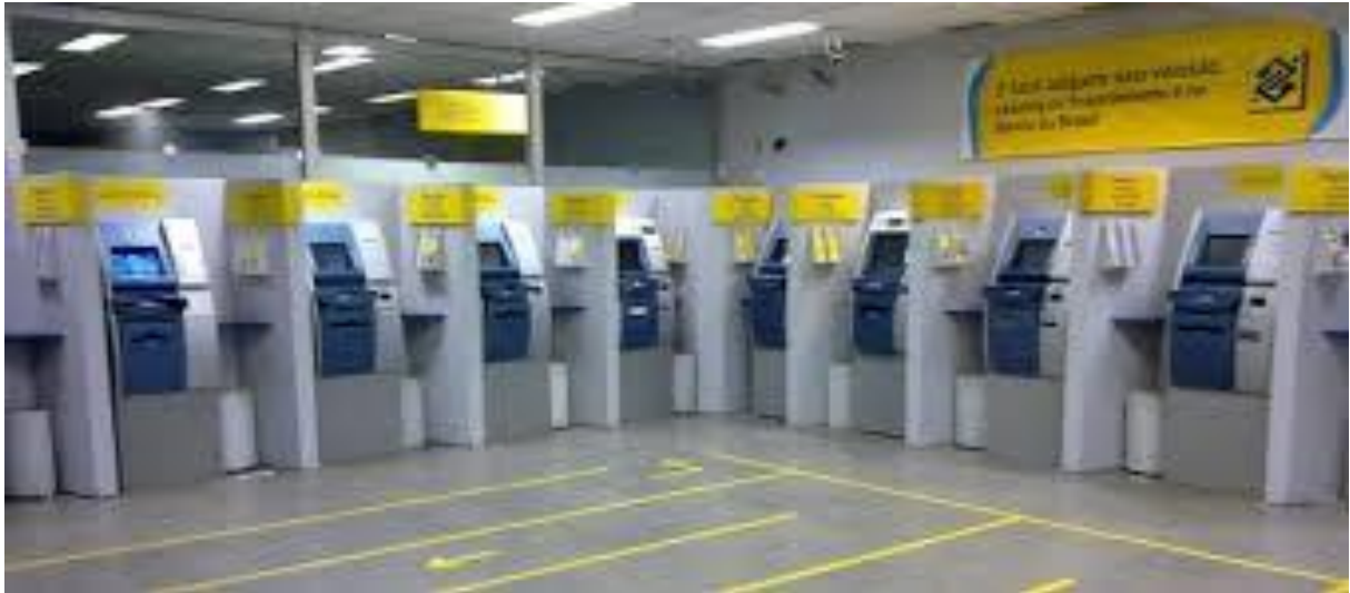
Figura 15: Terminais bancários de caixas eletrônicos.
