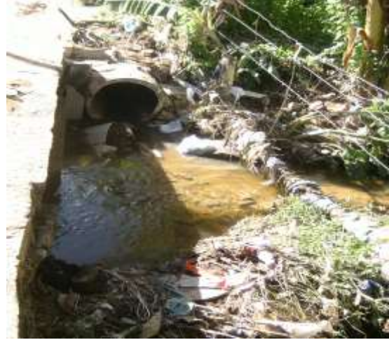
Figura 12: Esgoto direcionado ao Riacho da Serra, D. Inês/PB.
