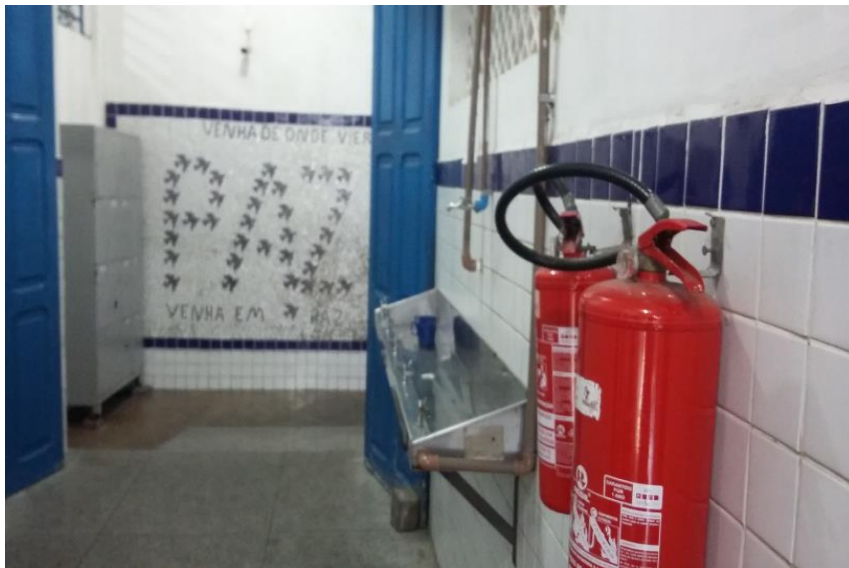
Figura 07 – Imagem do bebedouro e dos equipamentos de segurança contra incêndio da Escola Estadual de Ensino Fundamental Nossa Senhora do Rosário, em Campina Grande, PB.
