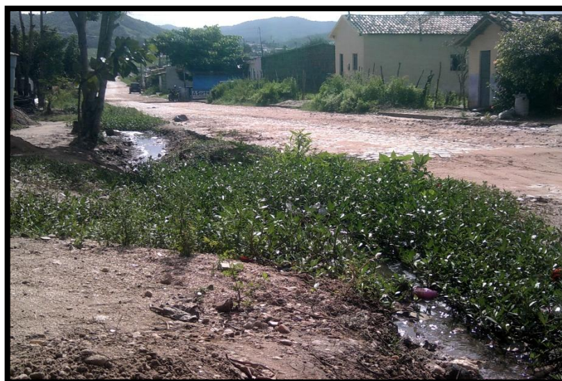
Figura 16 - Parte calçada da Rua do Sol toda coberta de terra e seixos Fonte: Fotografia realizada pela autora em 26 de setembro de 2012.
