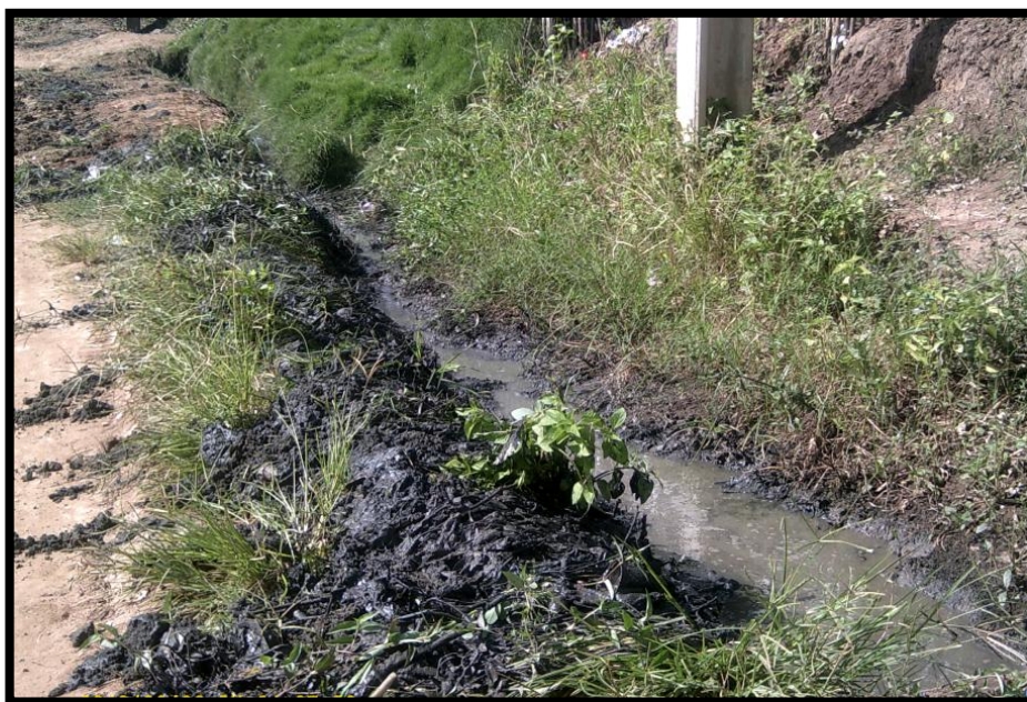
Figura 13 - Limpeza feita por um dos moradores da Rua do Sol em uma vala de esgoto
